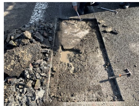
床版の土砂化
