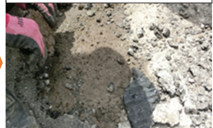
コンクリート床板の土砂化
