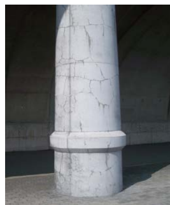
写真-3 支柱部の劣化
