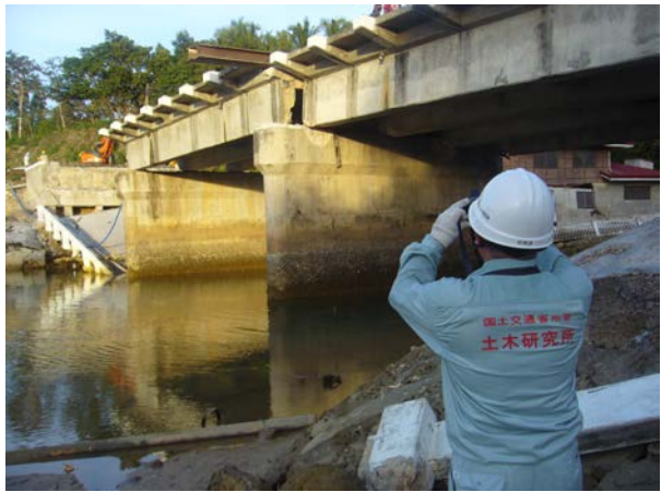
写真-1 落橋した橋の調査
