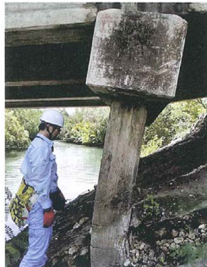
写真-2 地盤の変状に伴って生じた橋脚の傾斜
