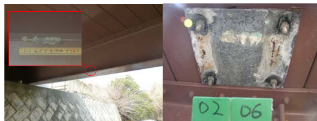
写真-1 橋梁の実態調査（左：外的要因による損傷、右：高欄取付部下面のペ-スプレートの腐食）
