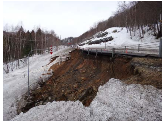
写真-1 国道 230 号の盛土法面の崩壊
