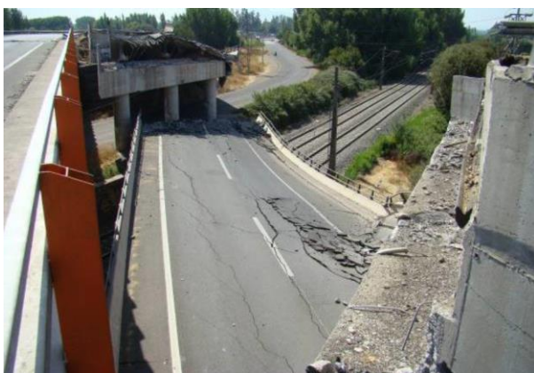
写真-1 2010年刊地震による高速道路の落橋被害（刊共和国公共事業省MOP提供）
