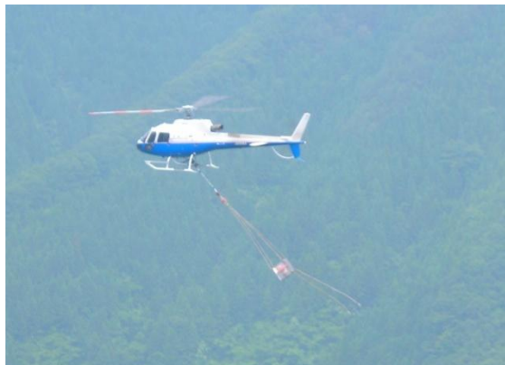
水位計の運搬状況
