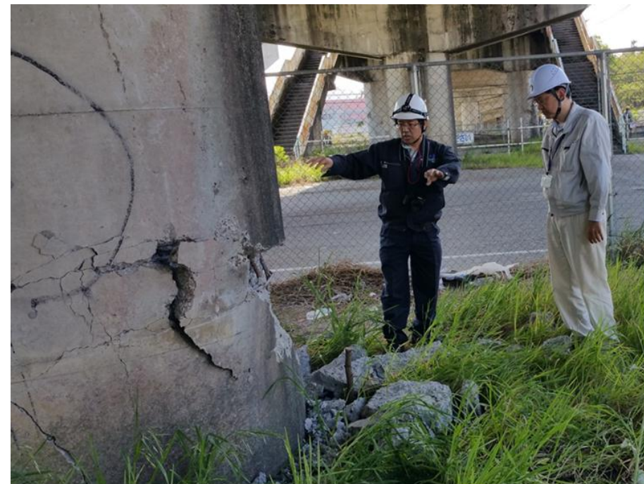
市道中央線 中央線陸橋現場において、熊本市職員と被災状況調査を行う土研構造物メンテナンス研究センター 職員(4月17日)
