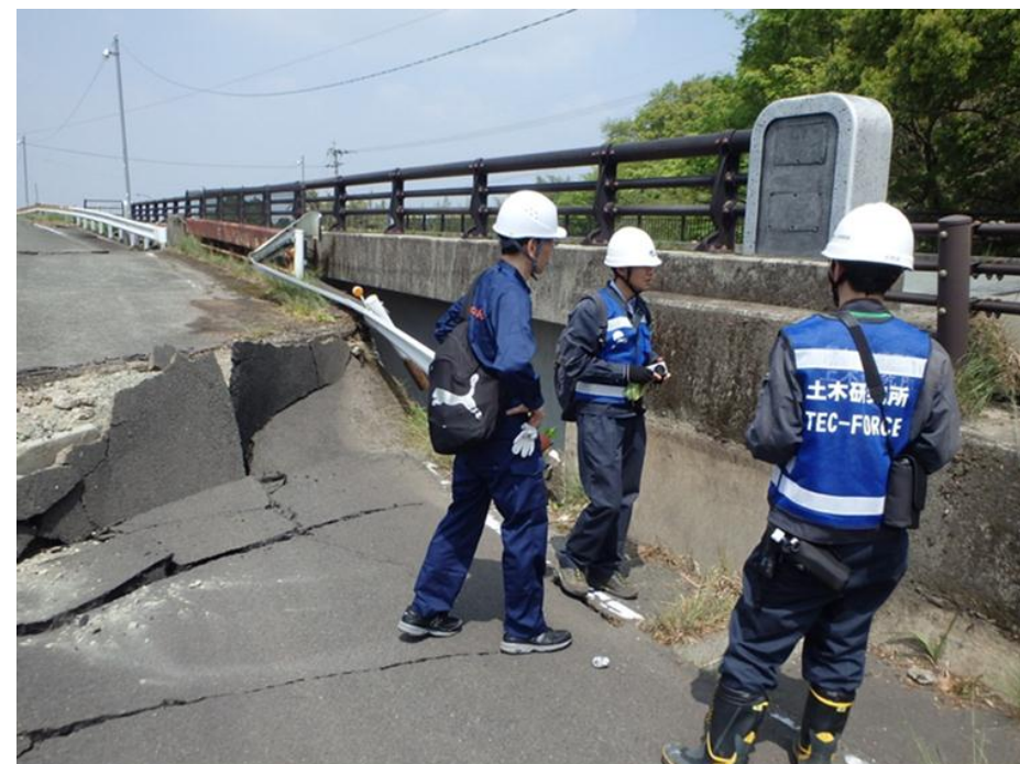
県道熊本高森線(大切畑ダム大橋)現場において熊本県職員と被災状況調査を行う土研構造物メンテナンス研究センター 職員①(4月18日)
