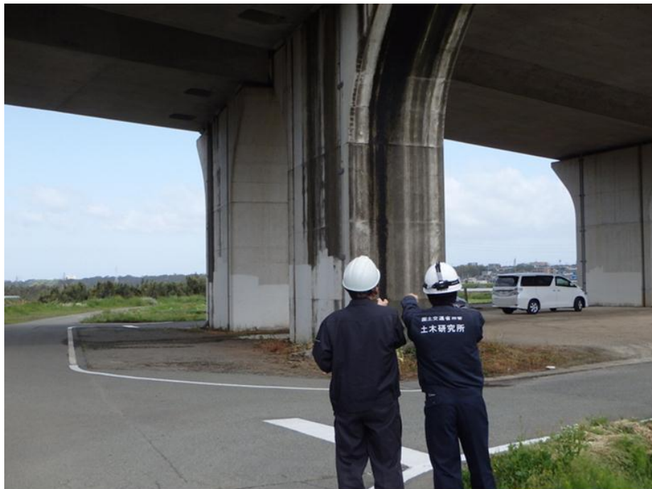
県道曲手水原線 鼻ぐり大橋現場において、熊本県職員と被災状況調査を行う土研構造物メンテナンス研究センター 職員(4月17日)
