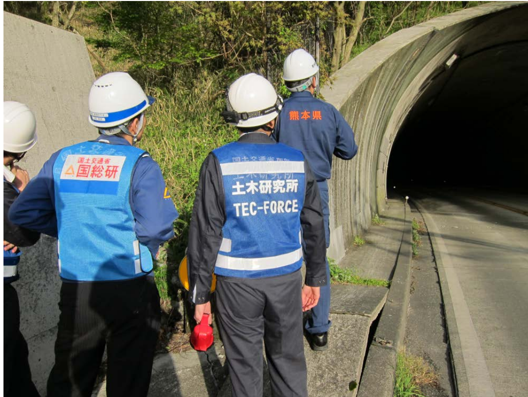
俵山トンネル覆工コンクリート崩落現場において 熊本県職員と被災状況調査を行う 土木研究所トンネルチーム上席研究員ら (4月17日)
