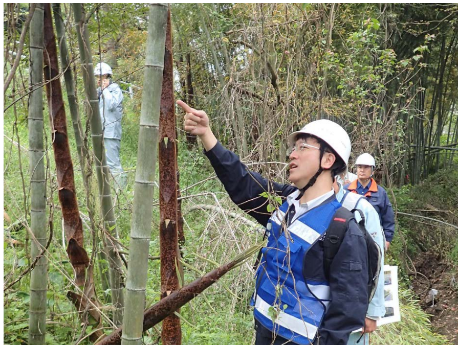
熊本県職員とともに益城町の盛土崩壊状況の調査を行う土研施工技術チーム上席研究員(4月17日)
