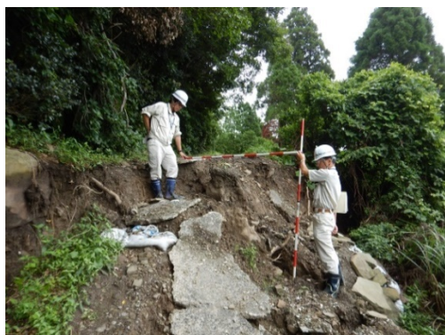
写真 滑落崖の状況
