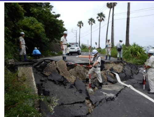
写真 段差状況
