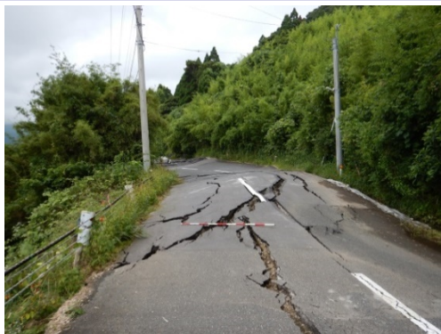
写真 路面の変状
