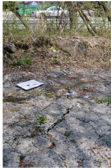
YnW-16地点の東側。東を望む。 杉型に複数の亀裂が入っている。
