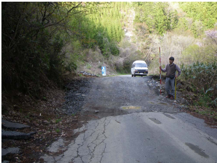
東を望む。断層の走向N5E、垂直変位量西落ち70cm。
