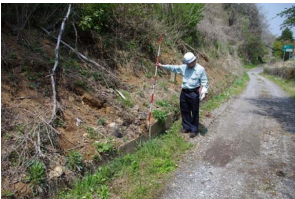
北を望む。 常磐道の東側管理用道路の西側斜面における亀裂。 走向N70E、垂直変位量は15cm、3cm右横ずれ。
