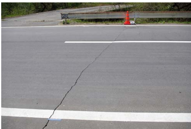
西を望む。 道路を横断する亀裂。 走向はほぼEW。 南側(写真左側)5cm程度下がっており、右横ずれ5~6mm程度みられる。
