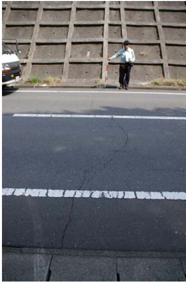
東を望む。 道路面に亀裂があり、法面まで連続する。 走向N75W、亀裂幅は2～3mm程度。
