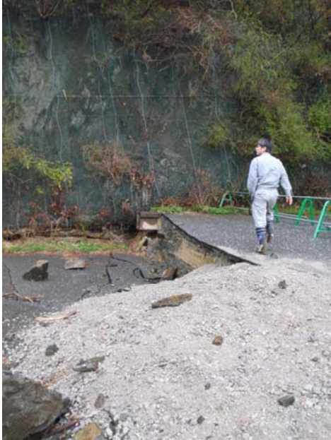
北を望む。路面の段差は120cm。写真のすぐ左には斜面崩壊が発生した。
