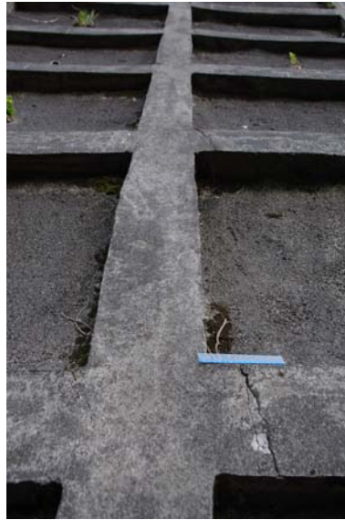
法面部の拡大写真。 亀裂が法面上部まで連続する。
