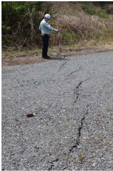
YnW-16地点の西側。西を望む。 杉型に4本の亀裂が入っている。 全体走向はN75W(1本1本はN60W)。
