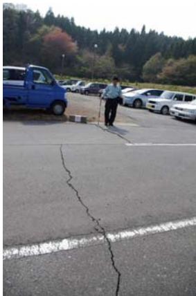
北西を望む。駐車場において発生した亀裂。
