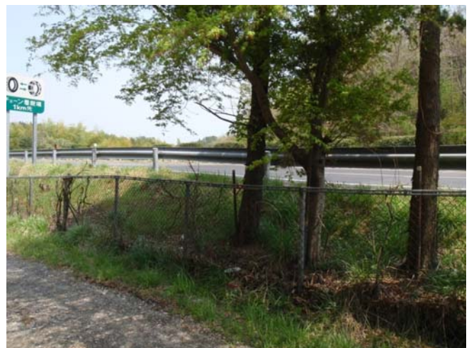
左写真の撮影位置から北東を望む。 高速道路の南側(写真右側)が沈んでいる。
