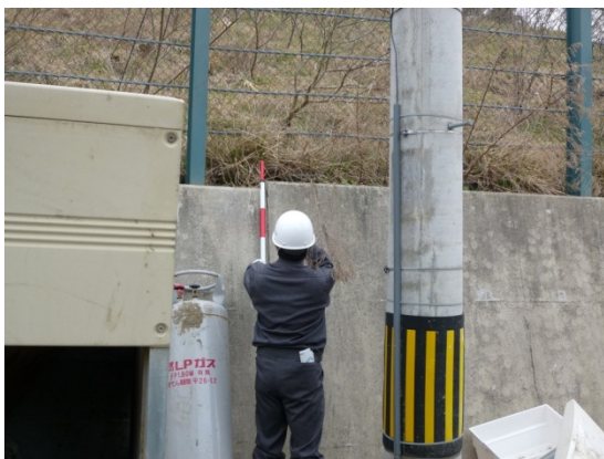
写真-4.5.3 擁壁工縦ズレ箇所
