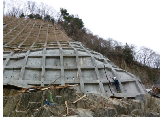
写真-4.5.6 法枠工目地部クラック（川尻地区）
