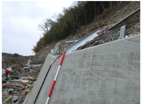
写真-4.5.8 擁壁工擦過痕
