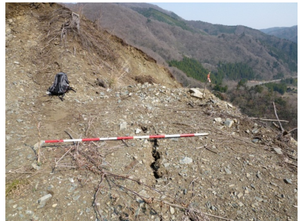
写真-4.6.10 斜面左側の作業道に見られたクラック
