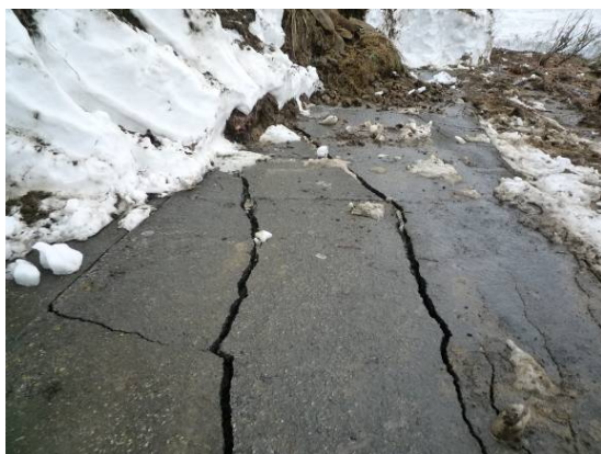
写真-4.3.19 路面の亀裂
