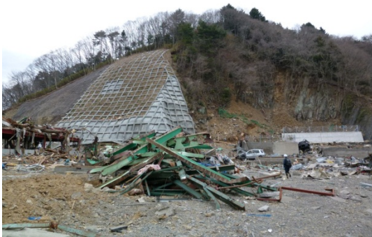
写真-4.5.1 法枠工右側の崩落（女川町）
