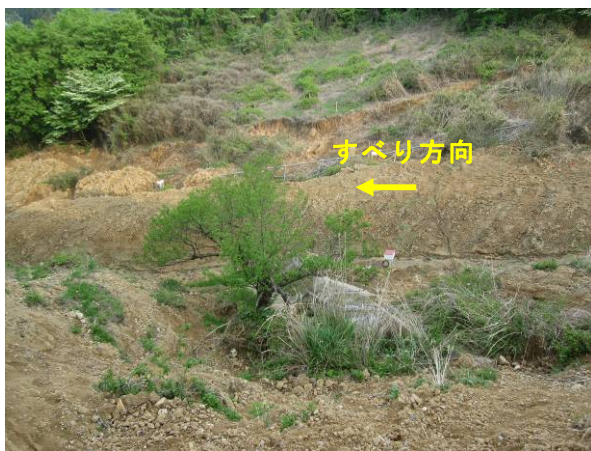
(c) 地すべり土塊の状況
