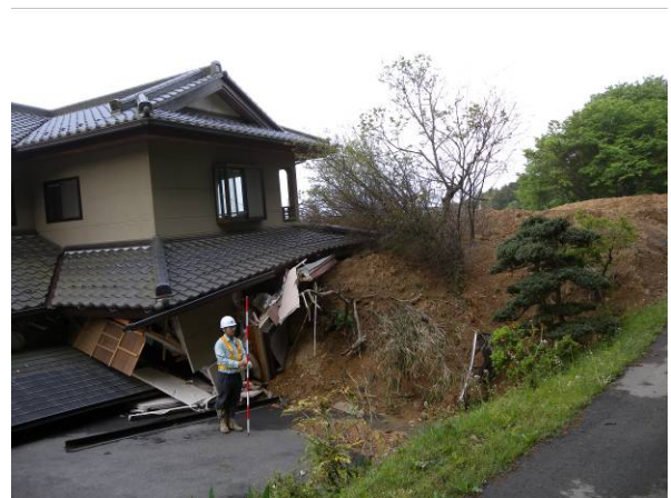
(f) 地すべり土塊による人家被害
