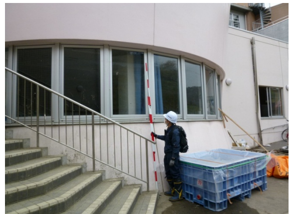
写真-4.5.12 老人福祉センター浸水痕 (ポール先端部)
