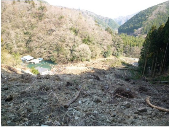
写真-4.6.5 人家まで到達した土砂 (崩壊中腹部のテラスから撮影)
