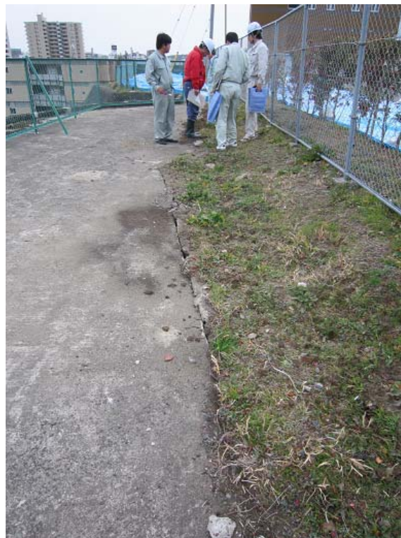
写真-4.4.4 駐車場にもクラックが入っている
