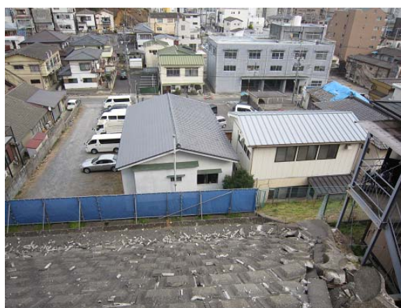
写真-4.4.2 斜面上端から斜面下方をのぞむ（のり砕工の破片が散乱している）
