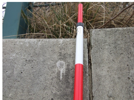
写真-4.5.4 擁壁工縦ズレ箇所（拡大）
