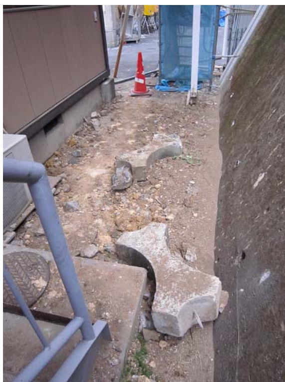
写真-4.4.5 斜面下部に落下したのり砕工の破片
