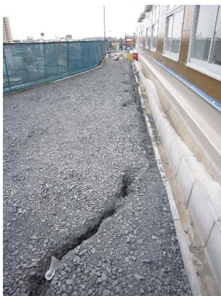
写真-4.4.1 建物沿いに入ったクラック
