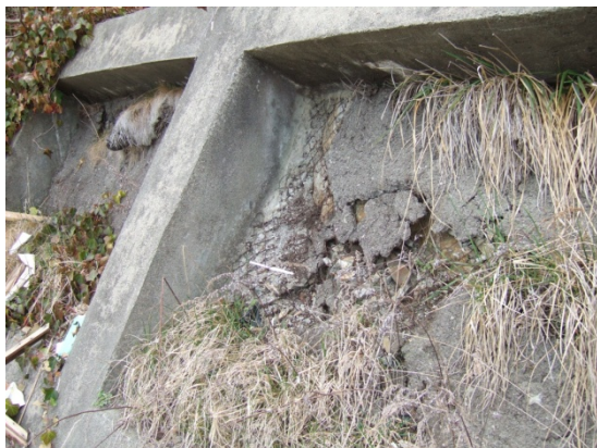
写真-4.5.9 吹き付け基材剥離状況
