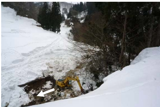
写真-4.3.16 地すべり斜面末端部の状況
