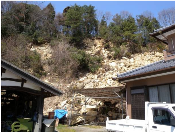
(c) 崩壊の状況
