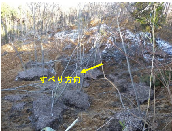
(e) 滑落崖直下の移動土塊の状況
