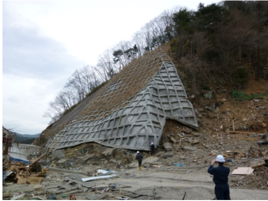
写真-4.5.5 法枠工脚部流出状況（川尻地区）
