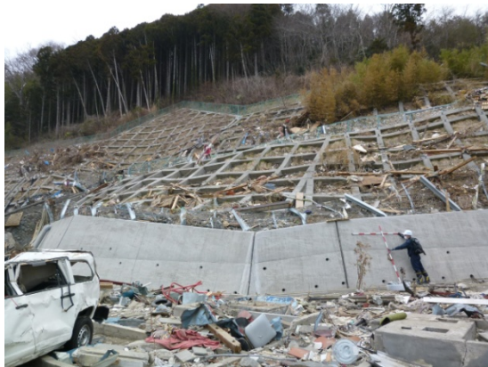
写真-4.5.7 ストーンガード座屈状況
