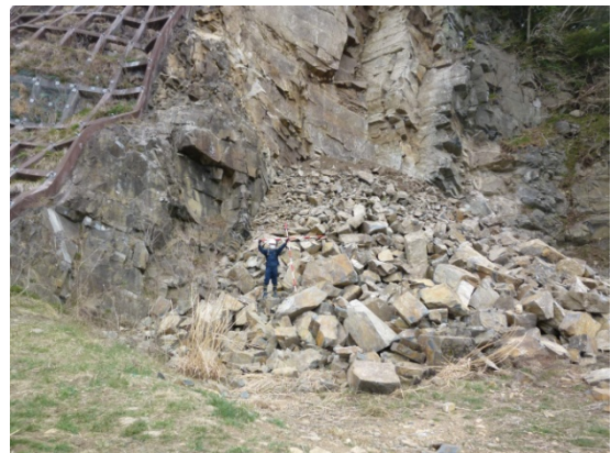
写真-4.5.2 法枠工右側の崩落（石巻市）
