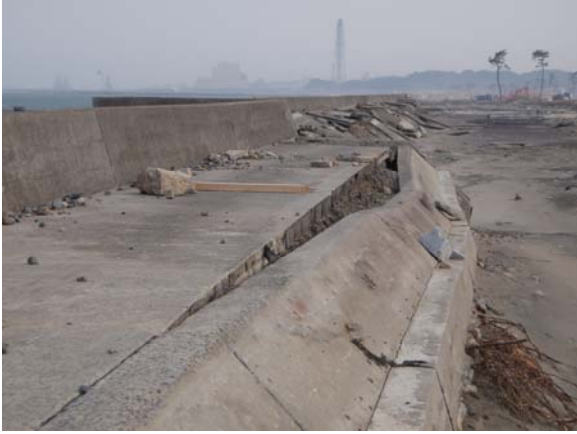
写真-5.4.119 堤防の裏法・天端被災
