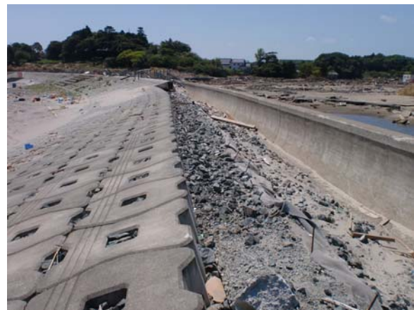
写真-5.4.98 緩傾斜堤天端被災状況
