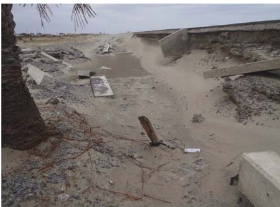
写真-5.4.152 護岸裏法被災（白幡海岸）
