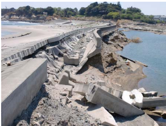
写真-5.4.97 緩傾斜堤の裏法・天端の被災状況。直立堤を改良した緩傾斜堤。
