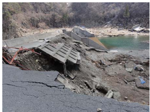
写真-5.4.41 堤防裏法・天端・堤体被災
