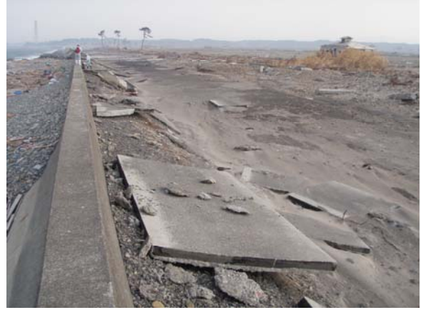
写真-5.4.120 堤防の天端・裏法被災、裏法尻洗掘溝
