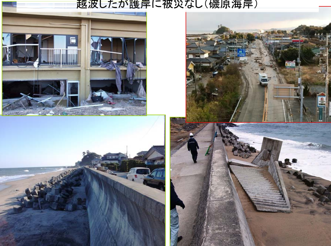
写真-5. 4. 124 被災軽微な護岸背後の被害
