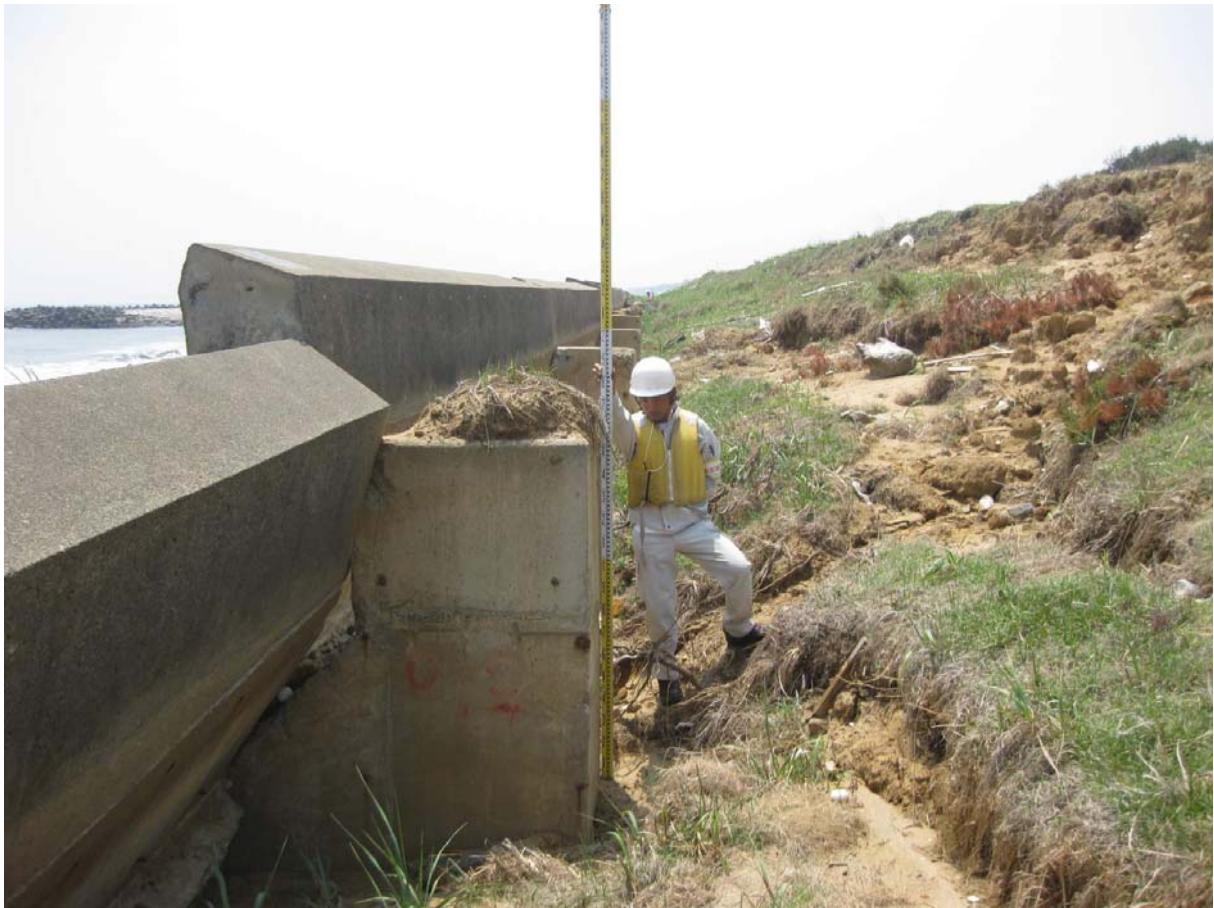
写真-5. 4. 131 護岸裏のすべり（成田海岸）
