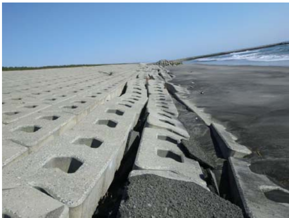
写真-5.4.16 引き波によると思われる表法被覆工の吸い出し
