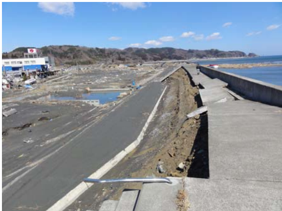
写真-5.4.56 天端保護工被災状況
