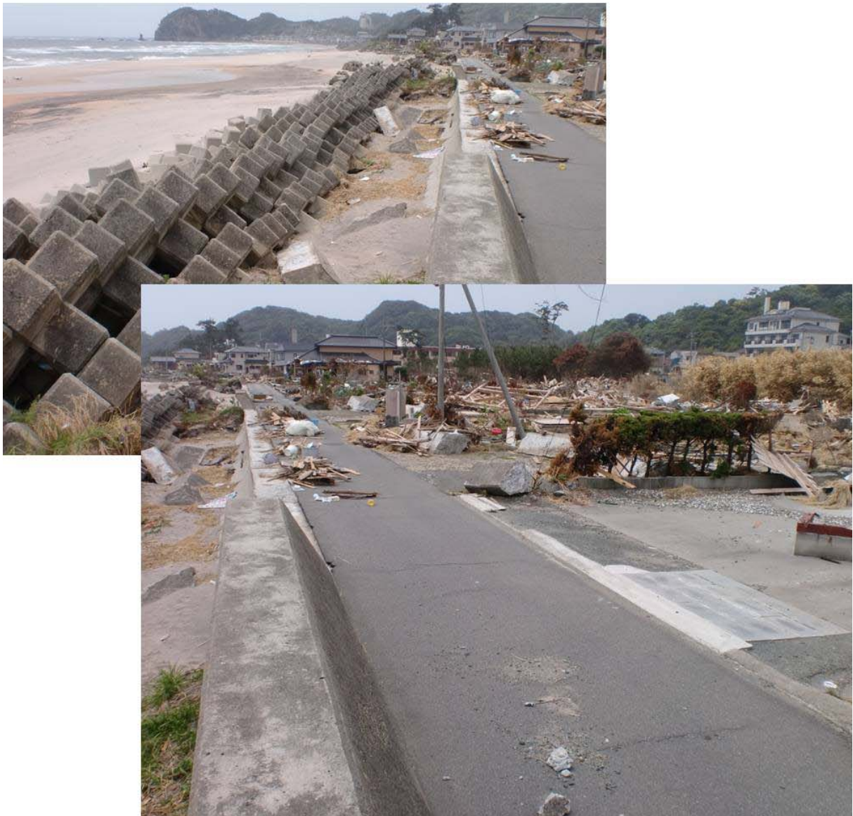
図-5.4.65 波返し工の倒壊。陸側への倒壊と海側への倒壊の両方が見られる（豊間地区海岸）
