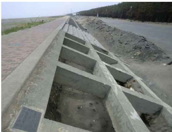
写真-5.4.10 格子枠工裏法被覆工の被災
