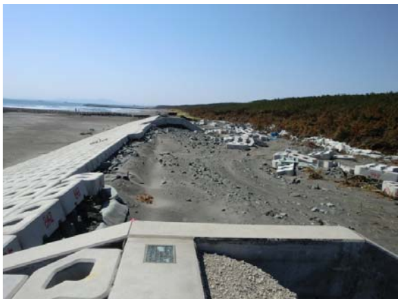
写真-5.4.7 裏法被覆工・天端保護工・堤体土の被災
