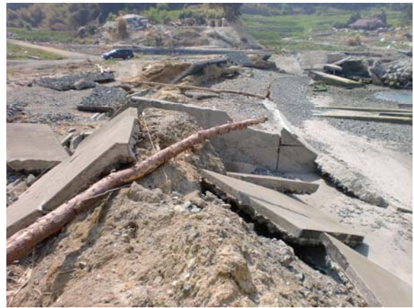
写真-5.4.108 堤防の全壊・破堤状況
