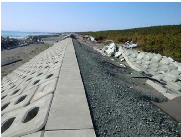
写真-5.4.5 裏法被覆工と天端保護工の被災
