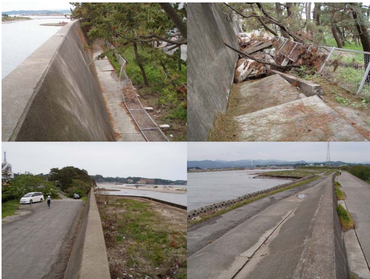
図-5.4.72 高い直立堤区間でも一部で法尻被覆工が沈下。背後地盤が高くなった区間では被災なし(植田佐糠地区海岸)
