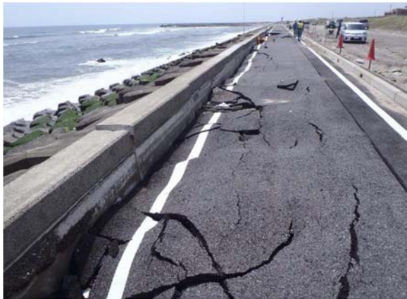
写真-5.4.141 護岸天端被災（野手海岸）
