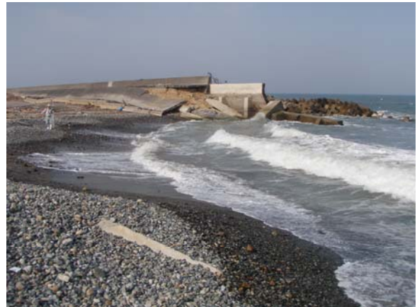
写真-5.4.116 破堤・全壊箇所
