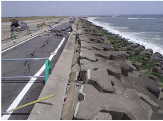
写真-5.4.139 護岸天端被災（野手海岸）
