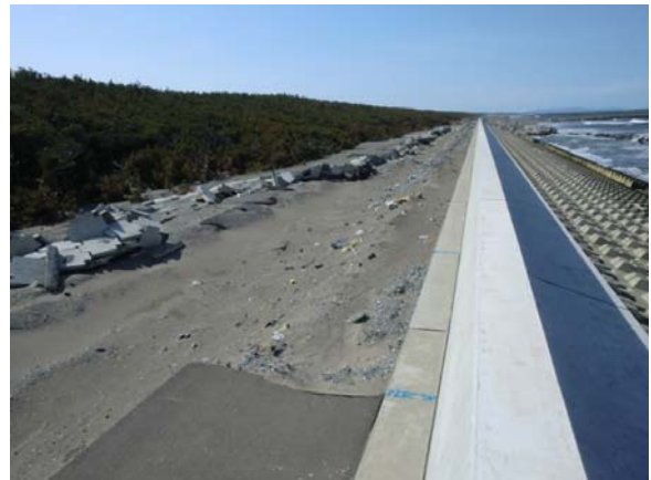
写真-5.4.8 裏法・天端保護工・堤体土の被災
