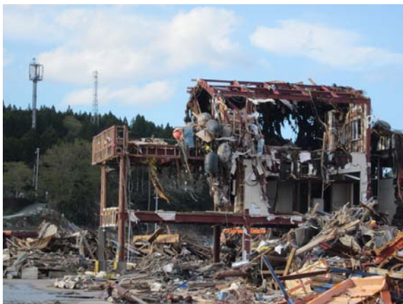
写真-5.4.77 3階の屋根より高い津波高
