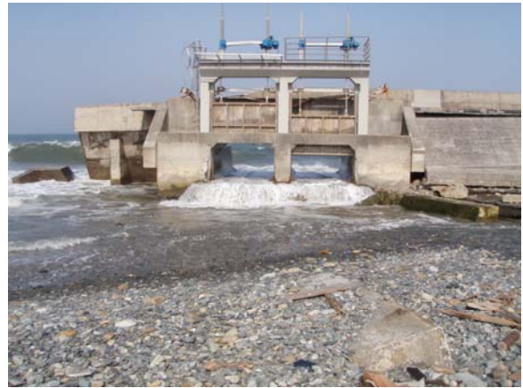
写真-5.4.114 破堤箇所。水門に隣接。
