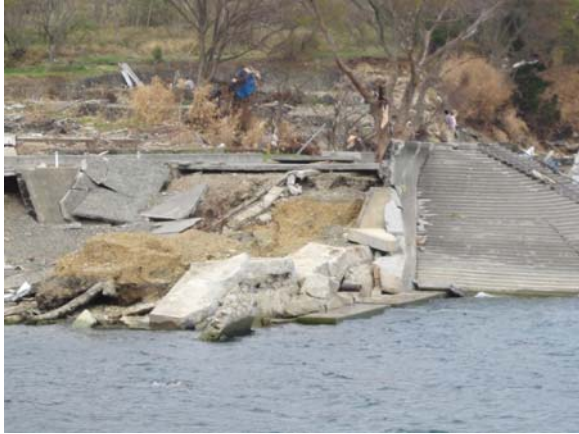
写真-5.4.65 破堤状況
