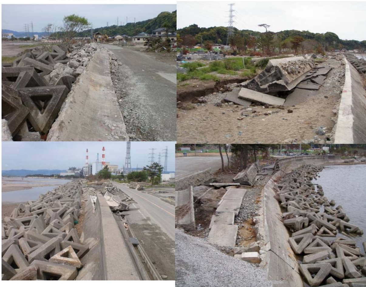
図-5.4.70 直立堤の倒壊（植田岩間地区海岸）
