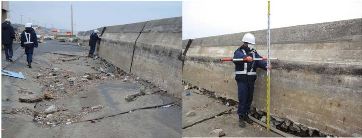
写真-5. 4. 123 天端陥没 (鉾田海岸)
