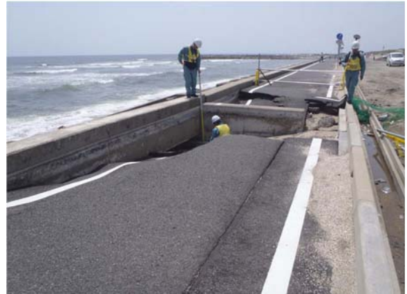
写真-5.4.142 護岸天端被災（野手海岸）
