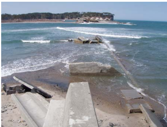
写真-5.4.87 破堤箇所（大浜地先海岸北部）
