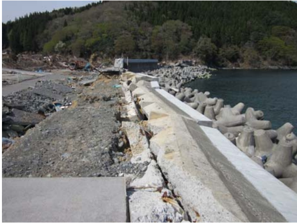
写真-5.4.69 表法被覆工海側への倒壊
