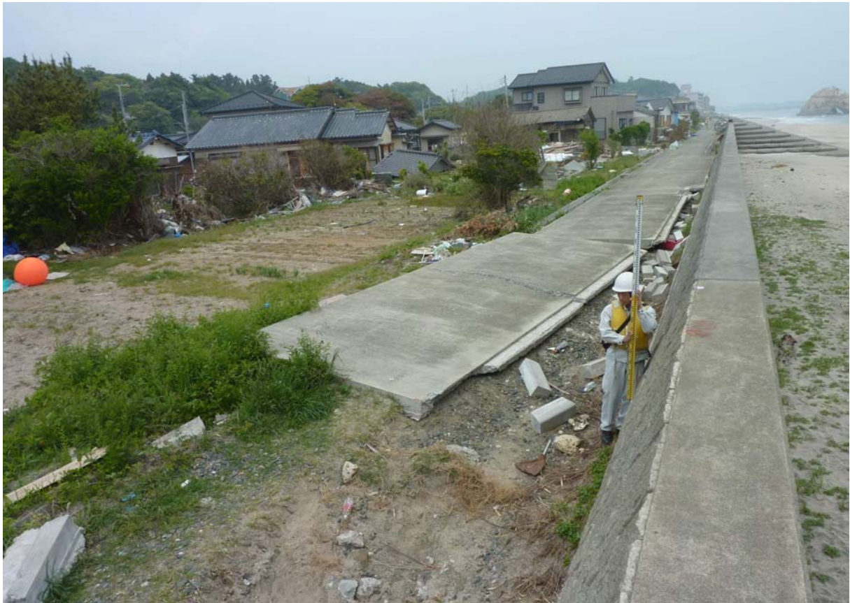
写真-5.4.127 天端保護工ずれ（磯原海岸）
