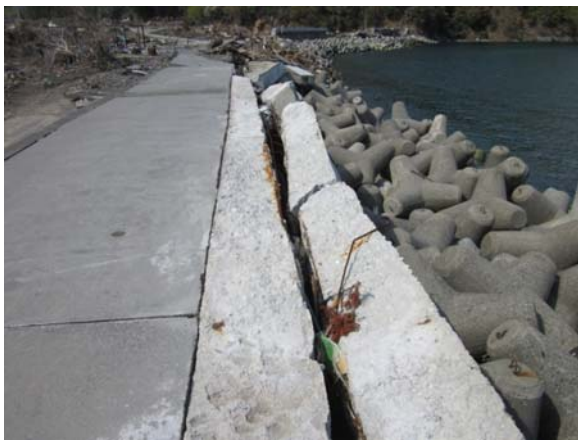
写真-5.4.71 波返し工海側への倒壊
