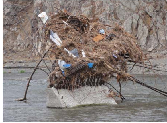
写真-5.4.43 ピア被災跡
