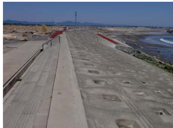
写真-5.4.100 緩傾斜堤被災していない箇所
