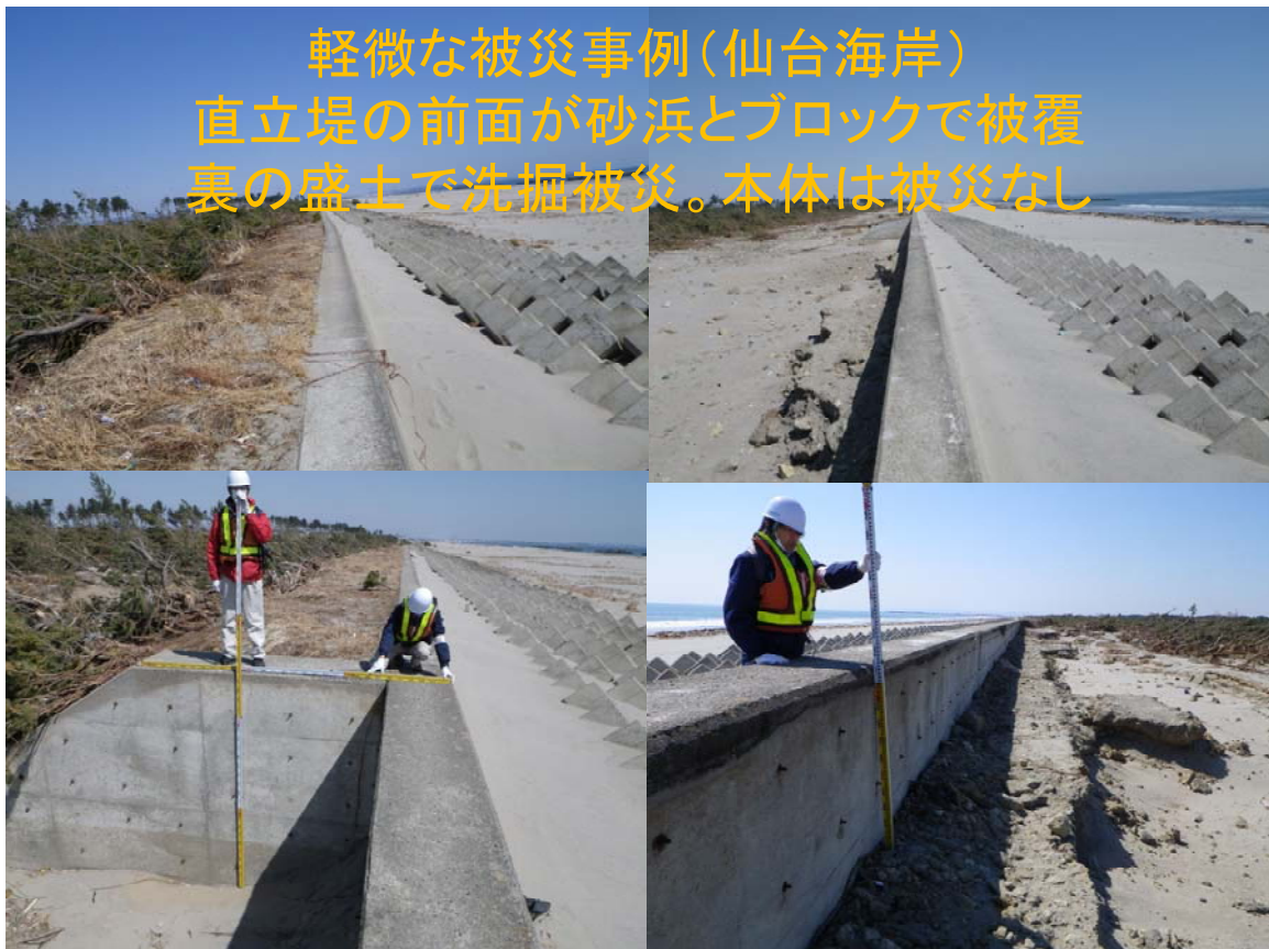
図-5.4.38 天端・裏法の洗掘、隔壁工で被災拡大防止
