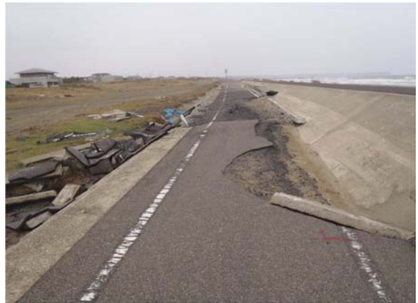
写真-5.4.137 法尻道路アスファルト洗掘（北九十九里海岸旭市）
