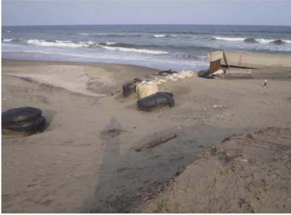
写真-5.4.147 護岸施工端被災（木戸海岸）
