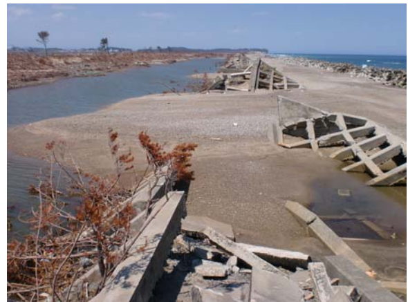
写真-5.4.93 歯抜け状の破堤
