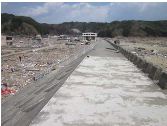
写真-5.4.49 二線堤陸側堤防被災なし (台 形断面)
