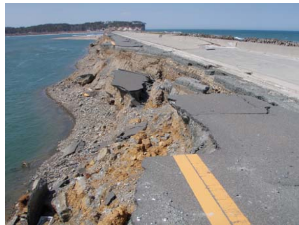
写真-5.4.88 背後にあった盛土道路が削り代となって破堤免れている（大浜地先海岸）
