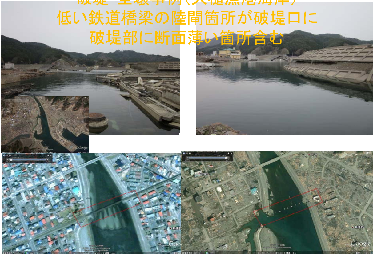
図-5.4.6 大槌川鉄橋破堤箇所
