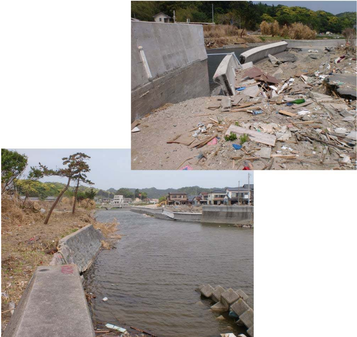
図-5.4.67 流入河川護岸の被災（豊間地区海岸）
