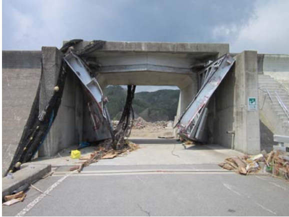
写真-5.4.51 陸閘の被災状況
