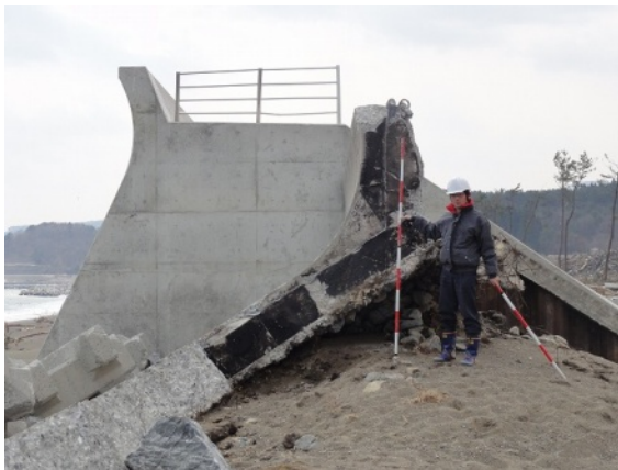
写真-5.4.20 海岸堤防被災箇所堤防断面の変化箇所
