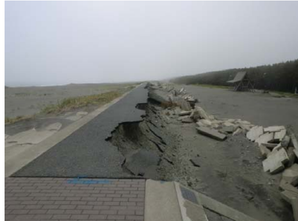
写真-5.4.6 裏法被覆工と天端保護工の被災
