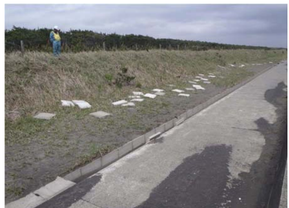
写真-5.4.155 護岸裏排水溝蓋散乱（東浪見）
