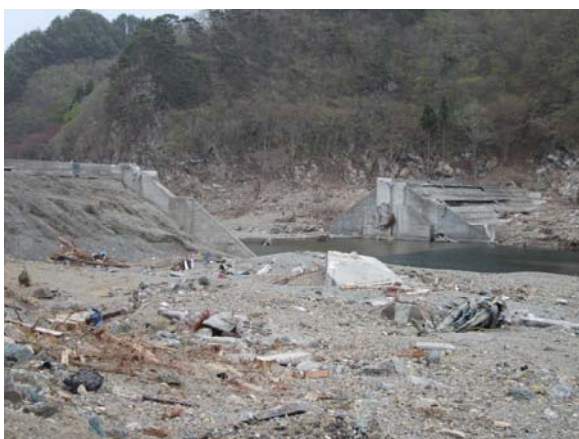
写真-5.4.40 全壊した接待水門
