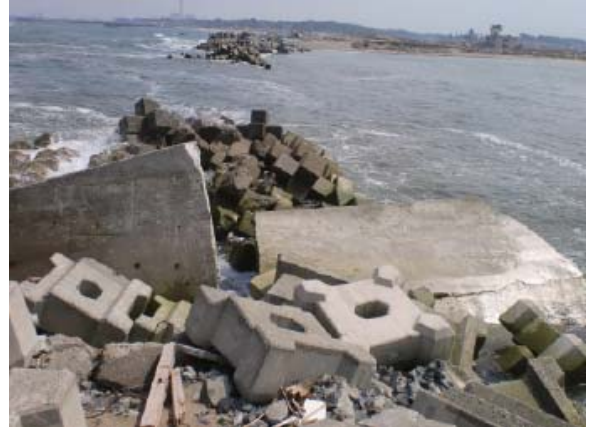
写真-5.4.84 破堤・全壊、海岸線後退（埴浜地先海岸）
