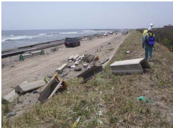
写真-5.4.140 護岸天端被災（野手海岸）
