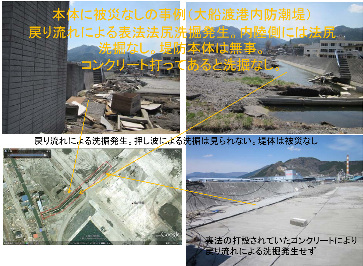
図-5.4.15 胸壁の表法尻洗掘
