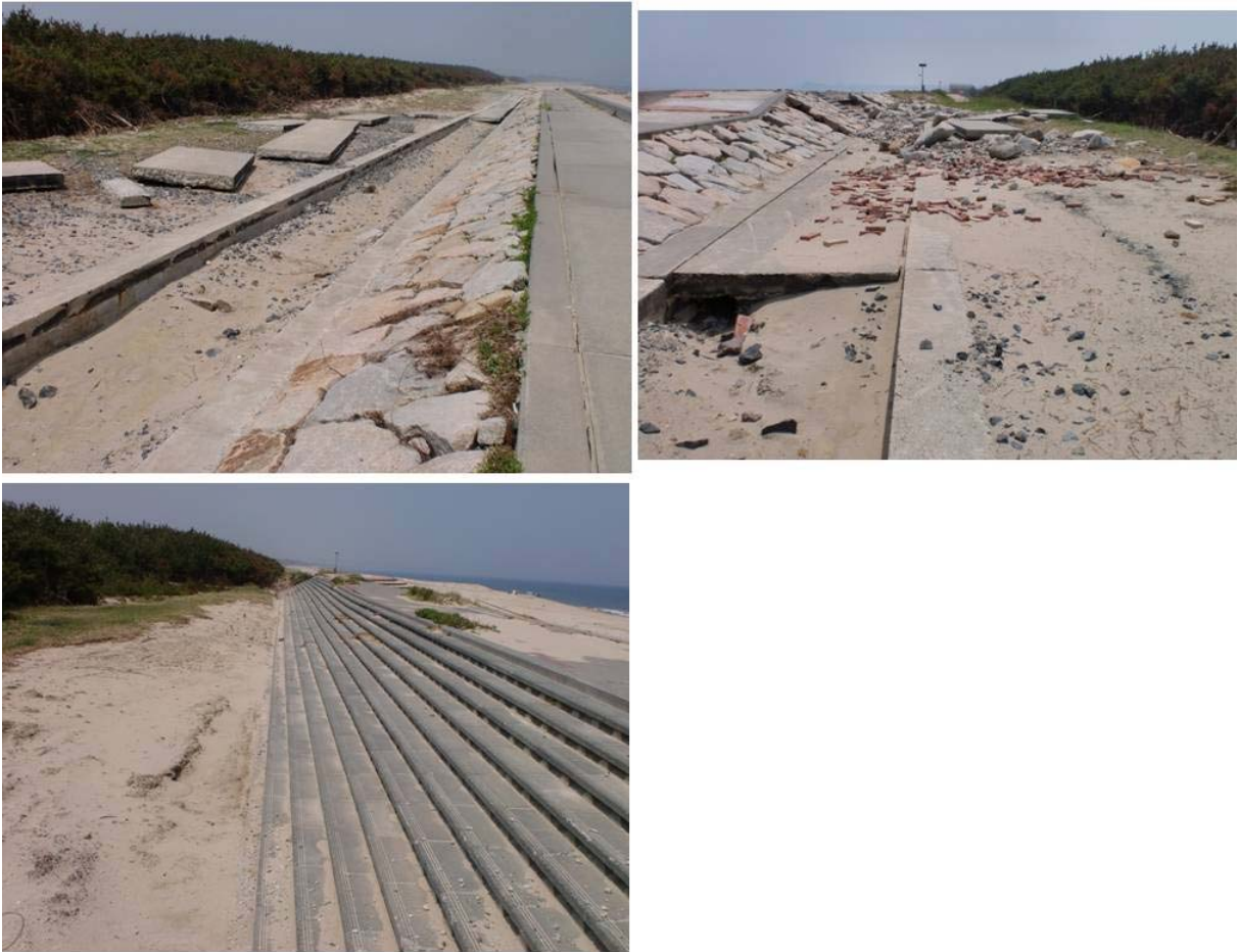
図-5.4.64 裏法尻の被覆工が流失。裏法被覆工が階段部分は被災なし(夏井地区海岸)
