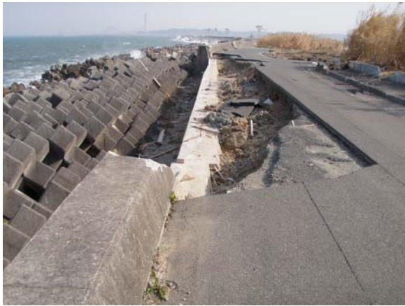
写真-5.4.113 堤防被災状況
