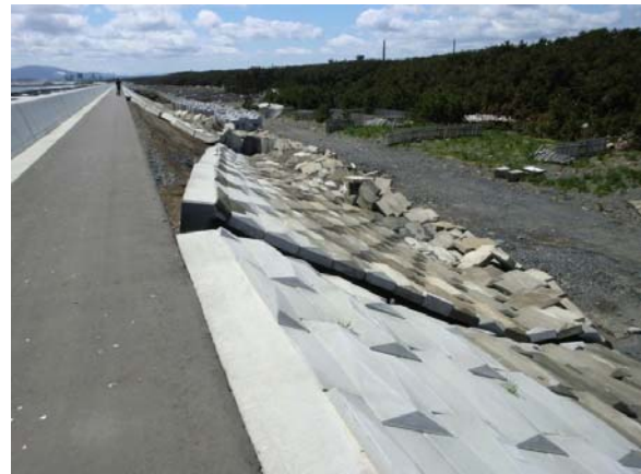
写真-5.4.2 裏法被覆工のずり落ち
