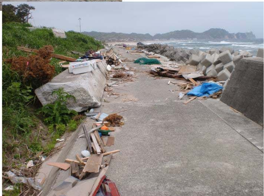
図-5.4.66 波返し工の倒壊。背後の盛土で倒壊したコンクリートが止まる（豊間地区海岸）
