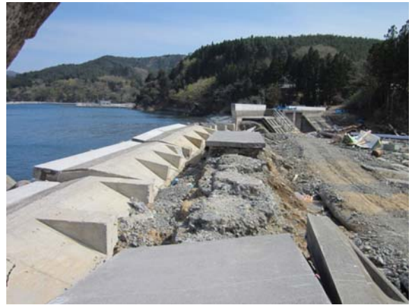
写真-5.4.70 表法被覆工海側への倒壊
