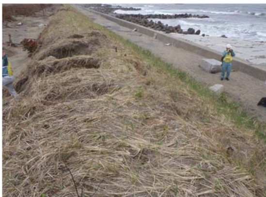
写真-5.4.135 盛土背後洗掘（飯岡海岸）
