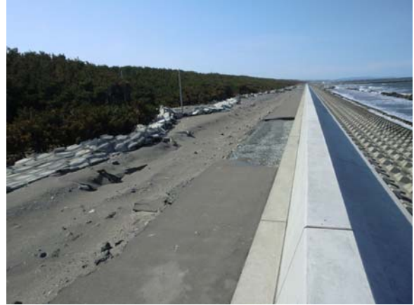
写真-5.4.4 裏法被覆工の背後への流失
