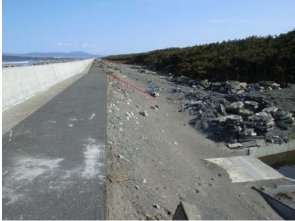
写真-5.4.3 裏法被覆工の背後への流失
