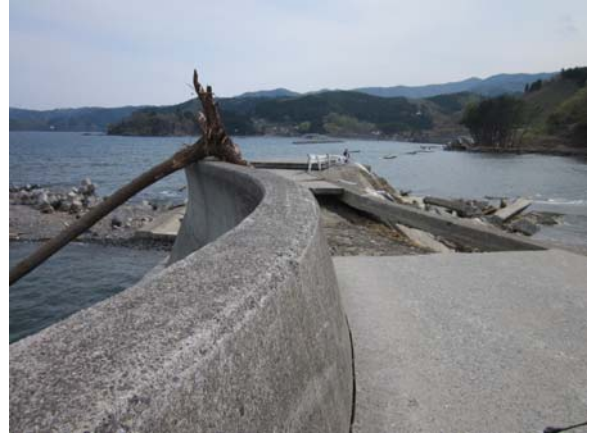
写真-5.4.66 破堤・海岸線後退状況
