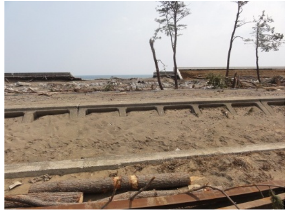
写真-5.4.19 陸側堤防から見た海側堤防被災箇所(堤防高が異なっている)
