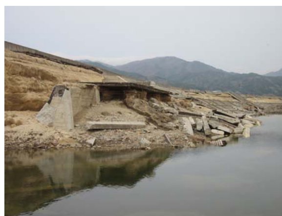
写真-5.4.53 裏法被災状況
