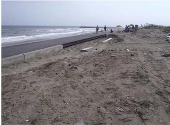
写真-5.4.145 護岸施工端被災（川辺海岸）
