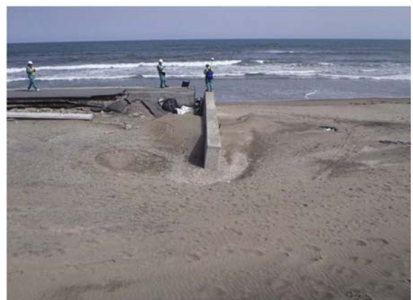
写真-5.4.144 護岸施工端被災（川辺海岸）
