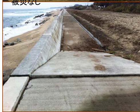
写真-5.4.129 天端の沈下・ずれ
