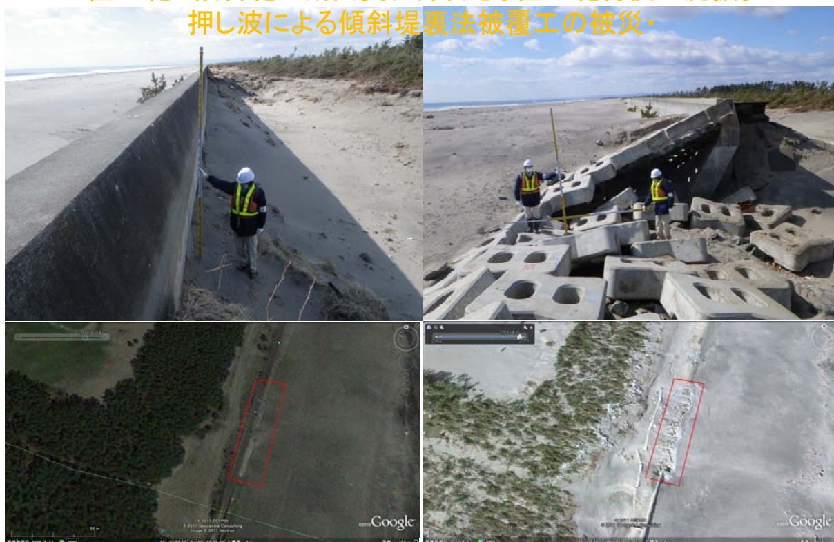
図-5.4.41 断面変化部で破堤・全壊
