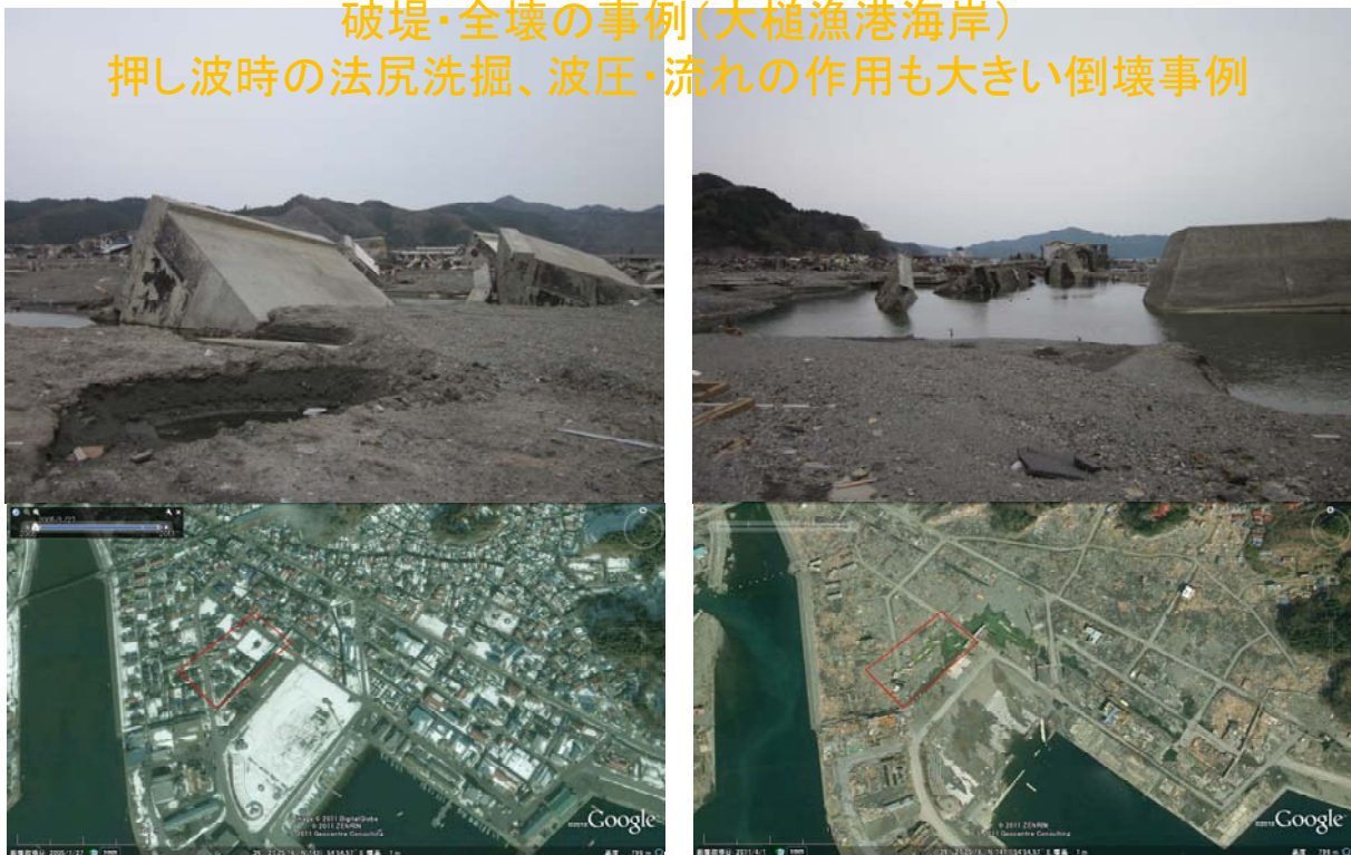
図-5.4.7 大槌漁港背後コンクリート直立堤倒壊箇所
