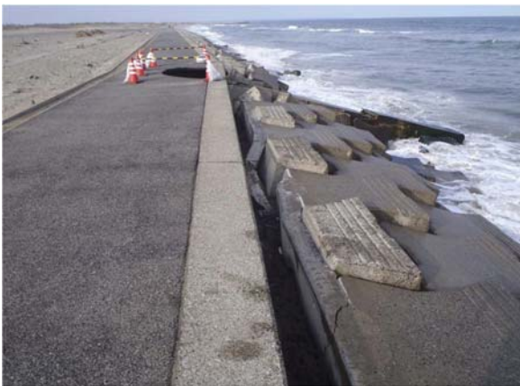
写真-5.4.149 護岸表法被覆工目地開き（木戸海岸）
