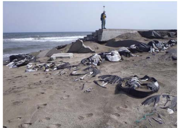
写真-5.4.143 護岸施工端被災（川辺海岸）
