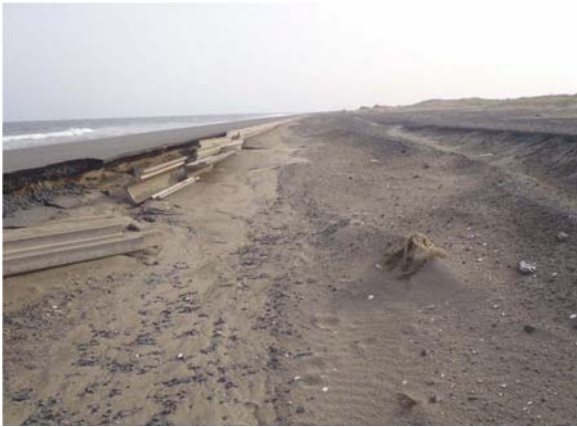
写真-5.4.148 護岸裏法被災（木戸海岸）
