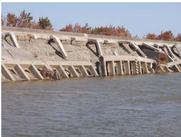
写真-5.4.94 天端・裏法が被災。法枠のみが残存して折損している状況。
