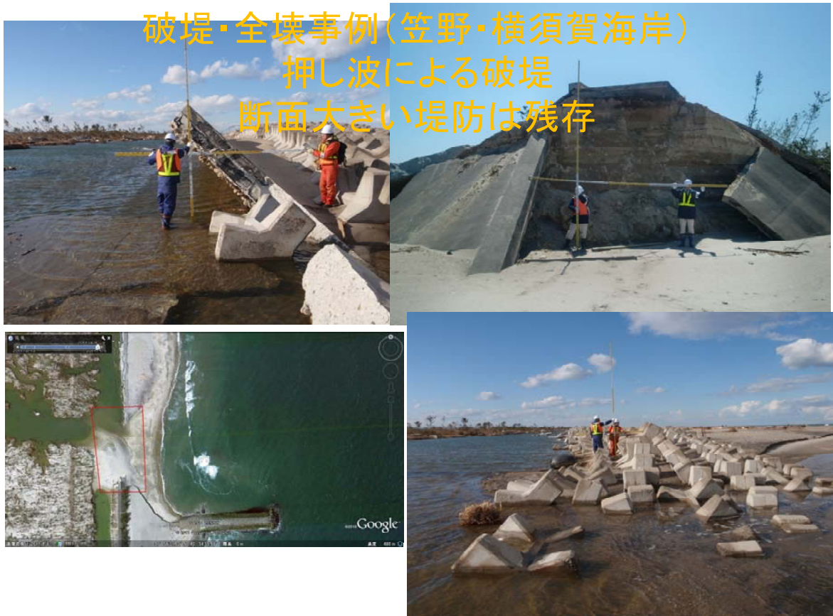
図-5.4.59 断面変化部分での破堤・全壊（笠野・横須賀海岸）
