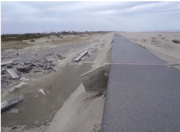
写真-5.4.151 護岸裏法被災（白旗海岸）
