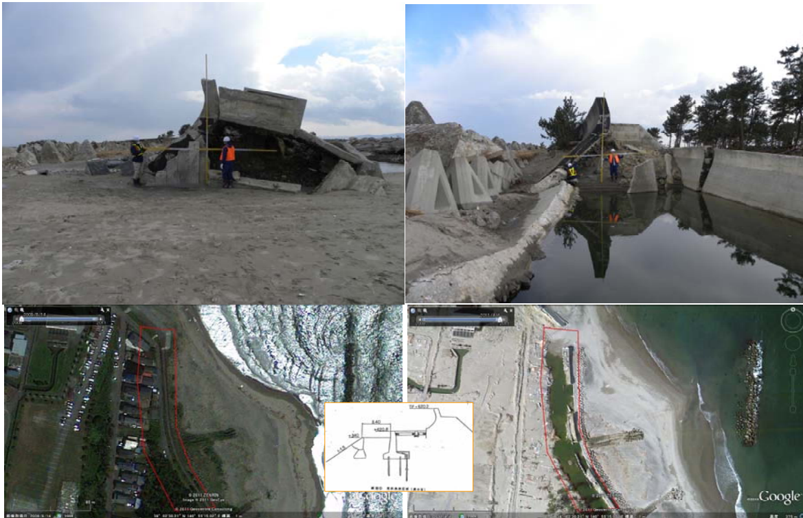
図-5.4.53 河川堤防との境界で歯抜け破堤（荒浜漁港海岸）
