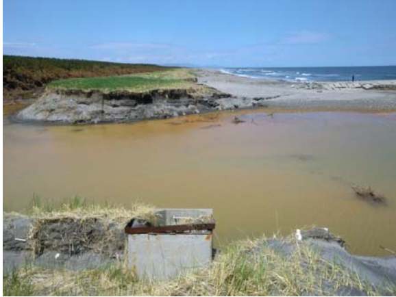
写真-5.4.14 引き波によると思われる排水路の流路拡大跡
