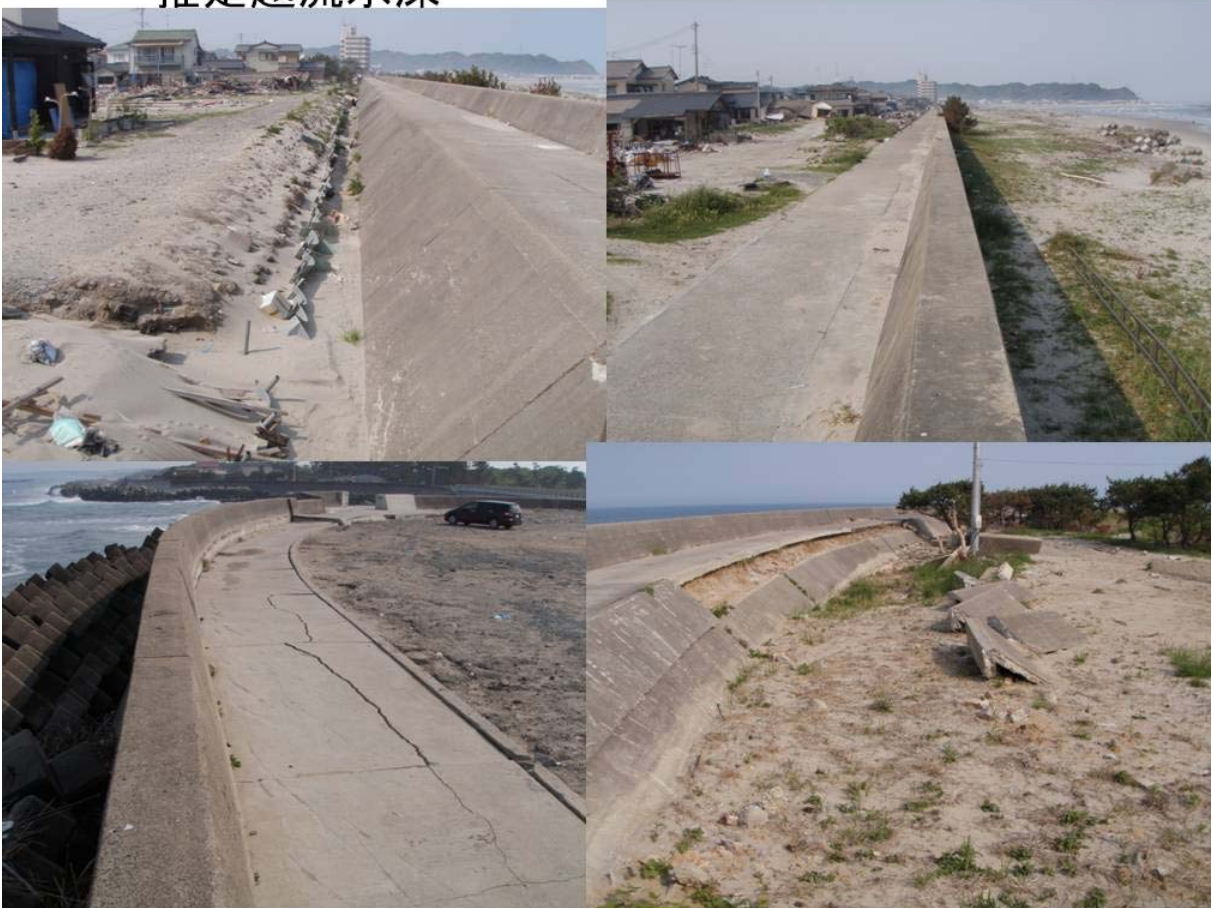
図-5.4.63 被災は軽微。一部で波返し工下の天端法肩が被災 (仁井田海岸)
