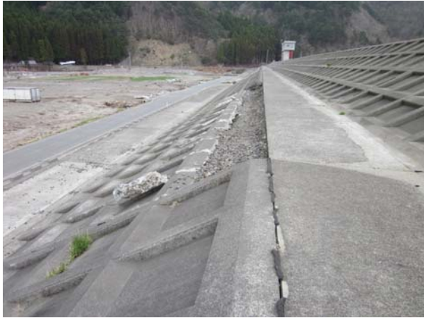
写真-5.4.36 北側堤防小段法肩の被災
