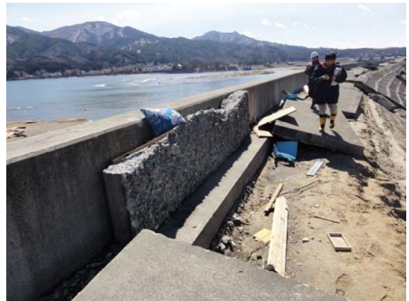
写真-5.4.57 天端保護工被災状況
