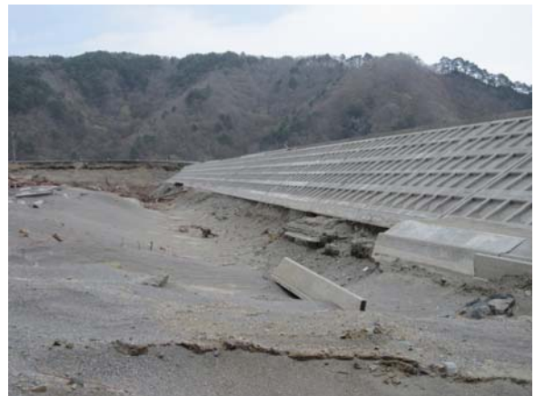
写真-5.4.39 南側堤防裏法尻被災と洗掘
