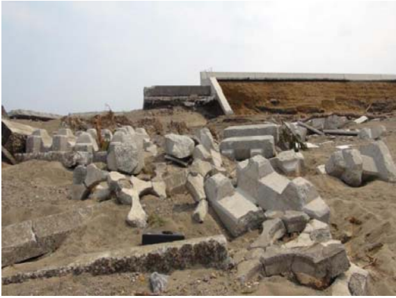
写真-5.4.18 海岸堤防の被災状況
