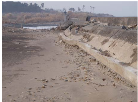
写真-5.4.118 堤防背後の洗掘状況
