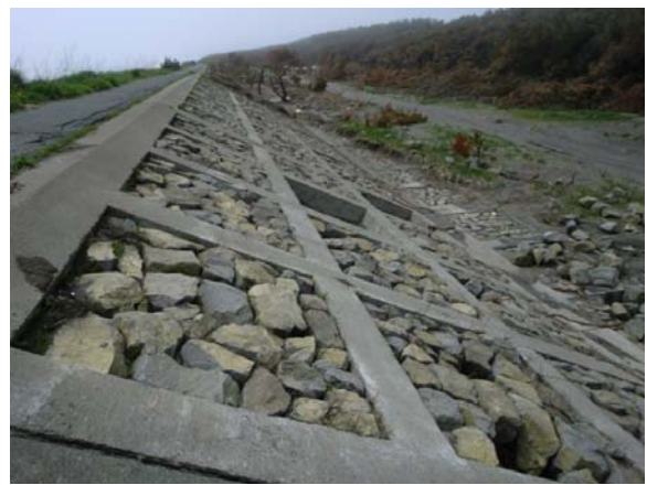
写真-5.4.11 格子枠工裏法被覆工の被災
