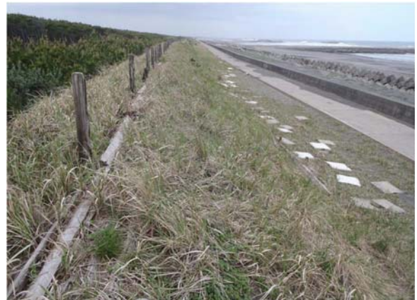
写真-5.4.154 護岸裏排水溝蓋散乱（東浪見）
