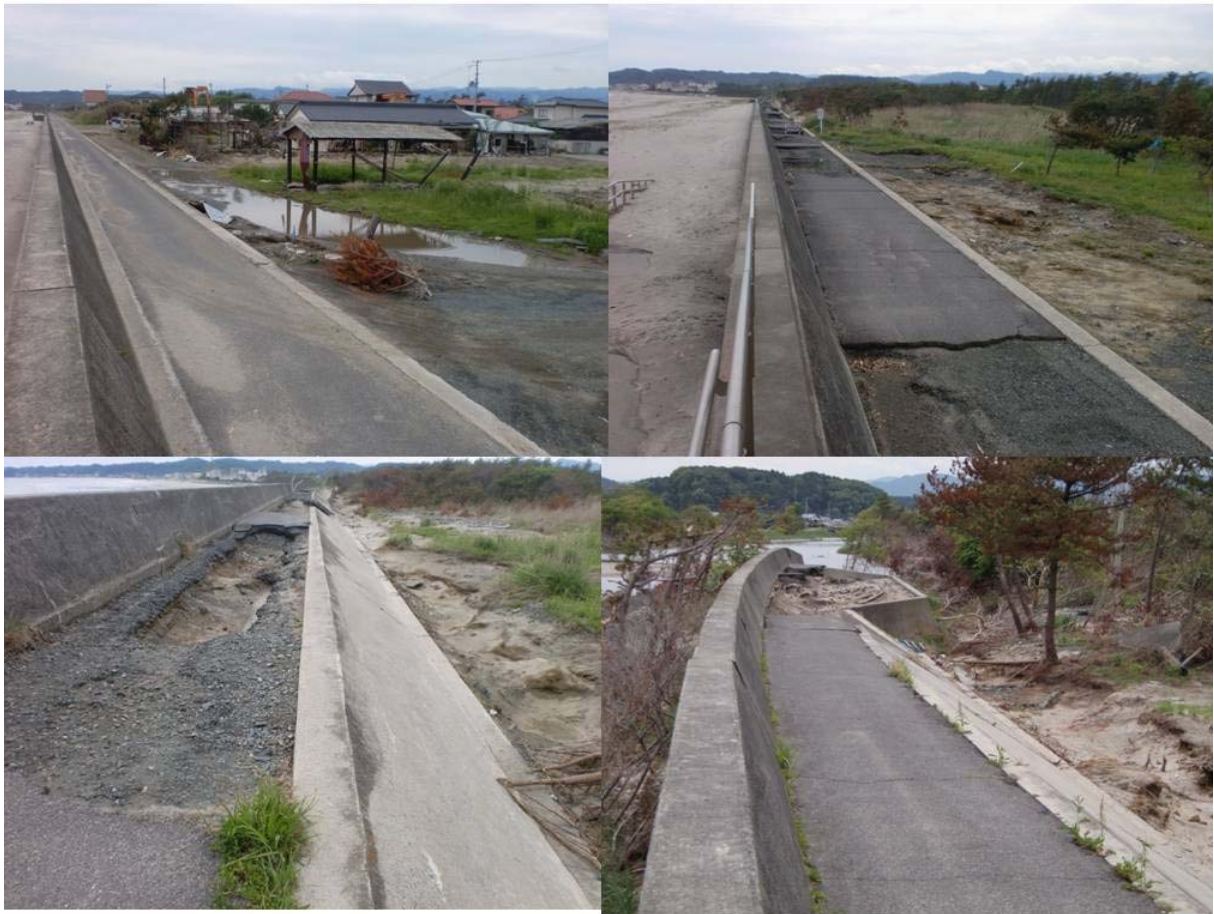
図-5.4.74 波返し工背後の天端被覆工が被災。高低差が増えると被災。(須賀地区海岸)
