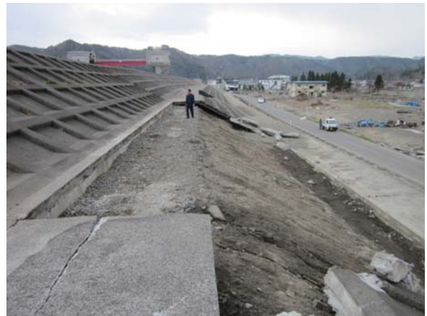
写真-5.4.37 北側堤防小段・裏法被覆工被災
