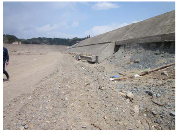
写真-5.4.48 二線堤海側堤防津波遡上方向 に向けた区間 (被災が軽微)
