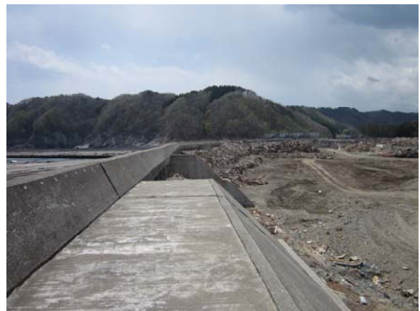
写真-5.4.50 二線堤海側堤防の被災状況 (波返し工付台形断面)
