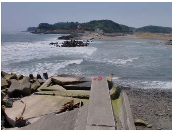
写真-5.4.105 破堤・全壊と海岸線後退
