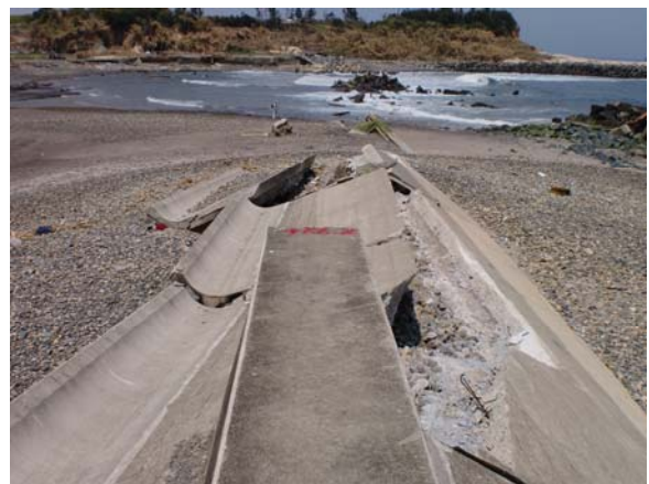
写真-5.4.106 破堤・全壊状況
