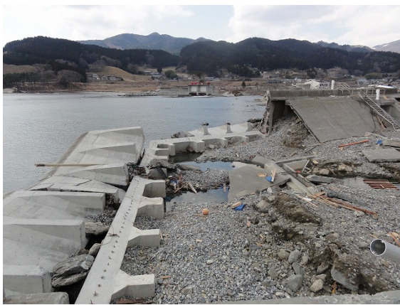
写真-5.4.67 表法被覆工倒壊状況
