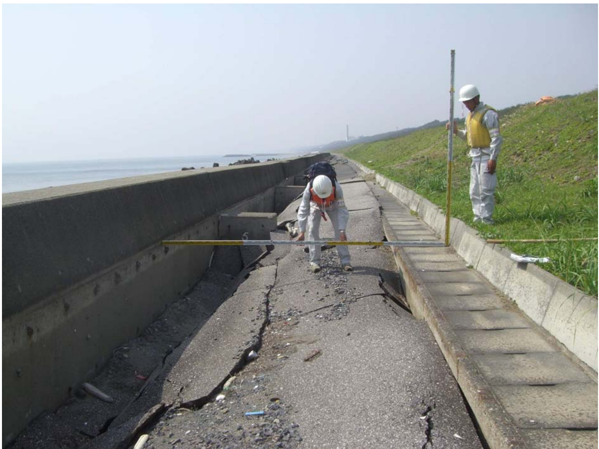
写真-5.4.122 天端陥没（大貫海岸）
