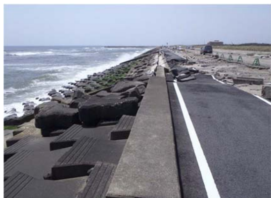
写真-5.4.138 護岸天端被災（野手海岸）
