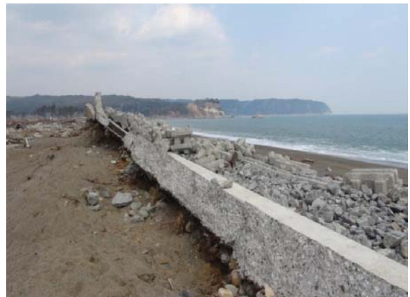
写真-5.4.21 海側堤防の被災状況
