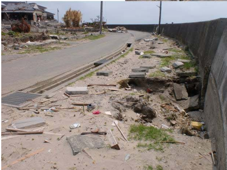
図-5.4.69 直立堤背後の洗掘発生。背後が道路でアスファルト舗装の被覆がされていると洗掘なし
