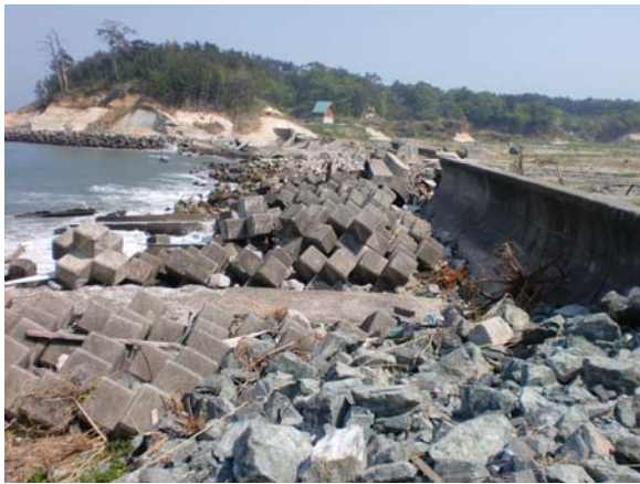
写真-5.4.107 堤防の被災状況
