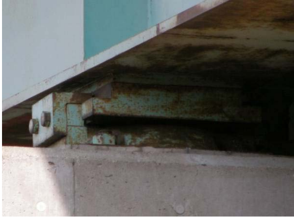
写真-9.166 P 1 橋脚G 1 桁支承：固定 支承とみられるが、大きな 変状はない
