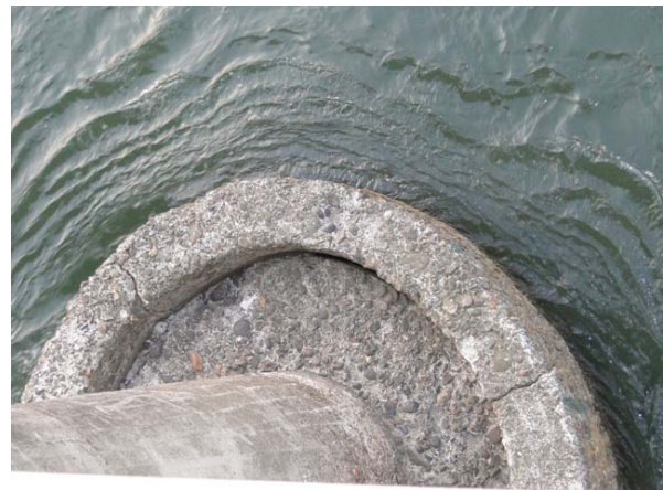
写真-9.93 P 4 橋脚のケーソン基礎(上流側)の天端の状況(路面から望遠撮影)
