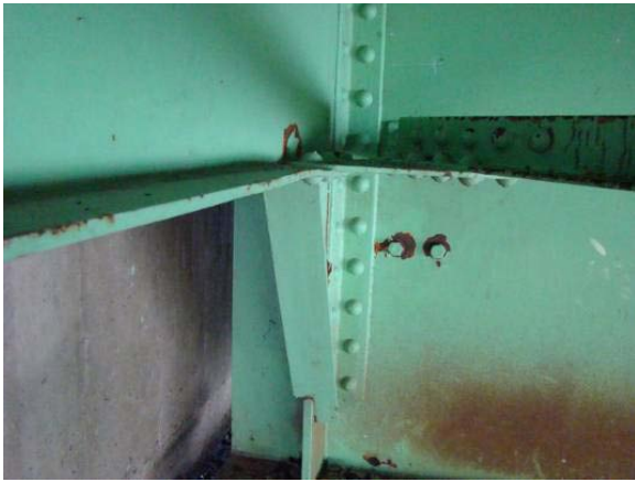
写真-9.51 支承横桁フランジの変形
