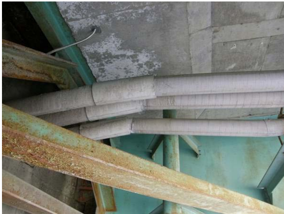
写真-9.162 添架物の損傷：桁端部で添架物が折損。以前からの損傷と最近出来た損傷が確認される。
