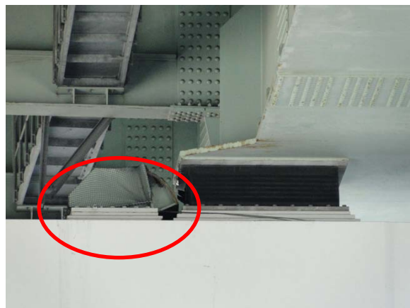
写真-9.73 ジョイントプロテクターの破損
