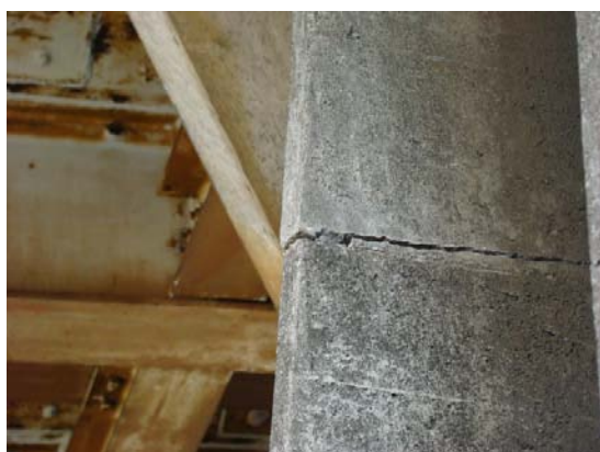
写真-9.29 A 1 橋台左側面のひび割れ
