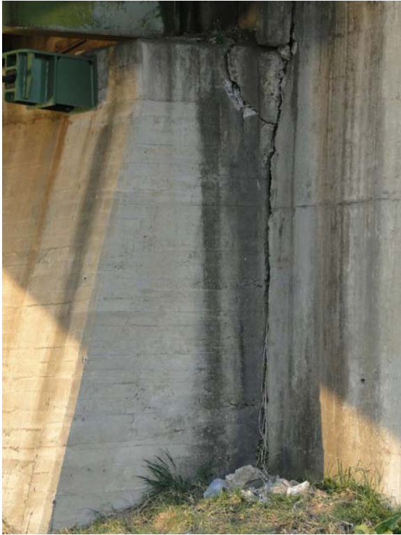
写真-9.102 A 1 橋台下流側ひび割れ部
