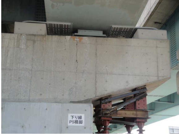
(a) 横ばりの損傷
