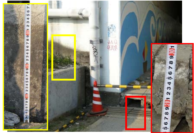
(d) 橋台と橋台前面護岸、橋台と一般部の鉛直変位差(約30cm)
