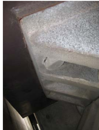
(f) 支承部(背面側)のボルトのゆるみ
