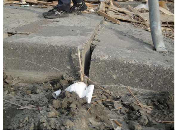
写真-9.142 橋台背面土の沈下による段差 (A 1 橋台周辺の歩道部)
