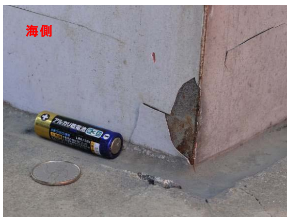
写真-9.76 P 5 2 橋脚の海側基部の塗膜剥がれ
