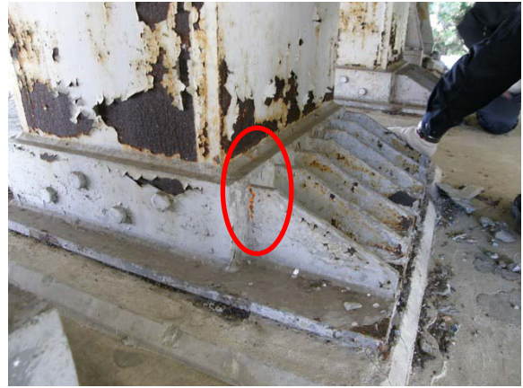
写真-9.12 P 5 橋脚上のストッパー（両方向固定）の塗膜剥がれ
