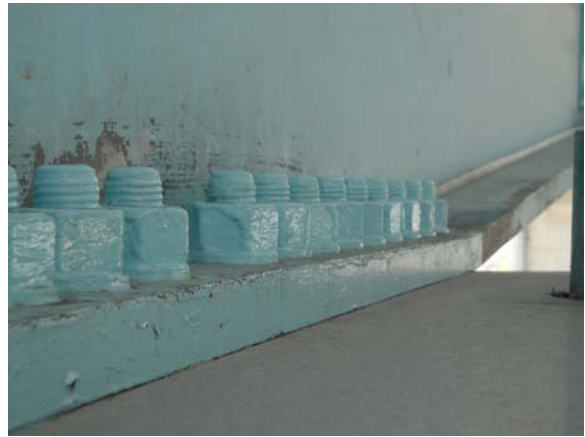
写真-9.43 支承取付部付近の鋼げたの塗膜のはがれ
