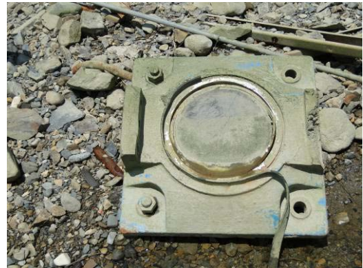
写真-9.117 流出した固定支承の下沓
