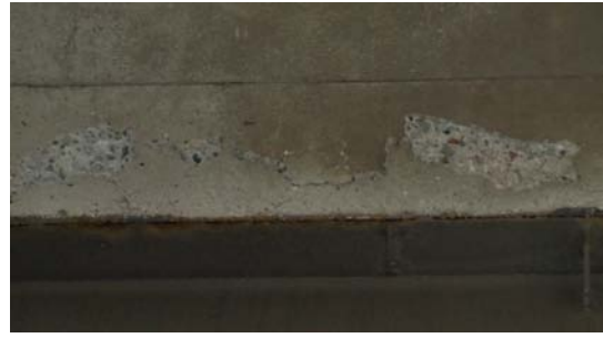
(j) 床板裏側の剥離部拡大写真
