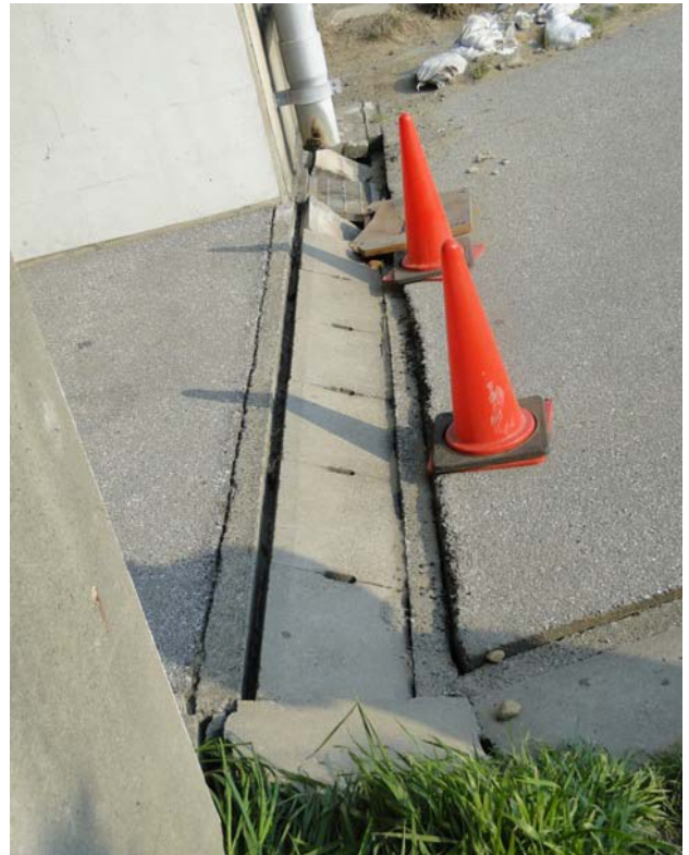
(c) 橋台周辺地盤の沈下により生じた、橋台側面の段差((a)のコーン設置位置)
