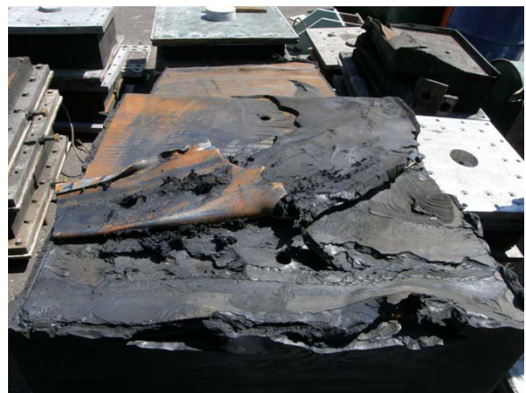
写真-9.71 ゴム支承の破断状況（主としてゴム本体部で破断）
