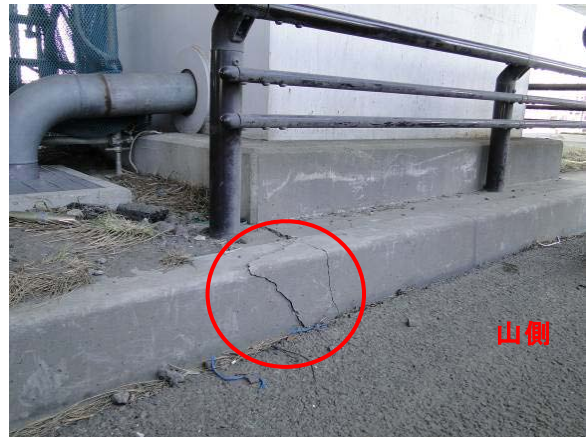
写真-9.79 P 5 6 の鋼製柱基部周辺コンクリートのひび割れ
