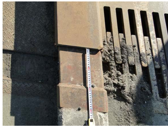
写真-9.14 A 2 橋台伸縮装置の水平移動の擦過痕（約5cm）
