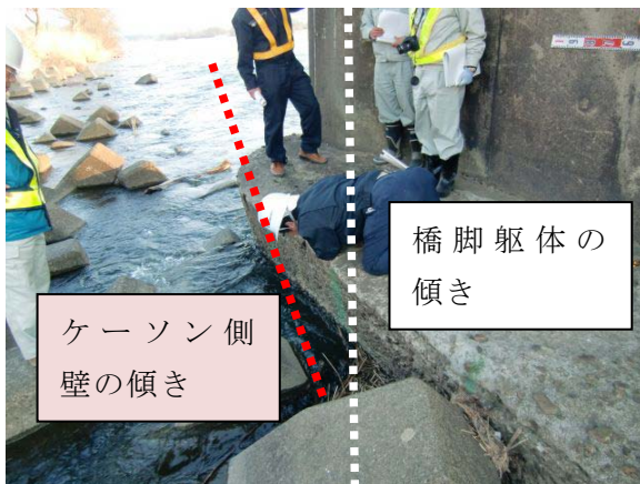
写真-9.100 P 2 橋脚のケーソン基礎側壁 上部のはらみ出し状況
