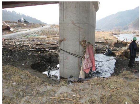
写真-9.146 P 1 橋脚基部の津波による 洗掘
