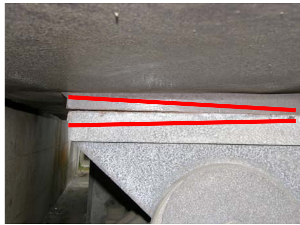
(g) 支承と桁のプレートとの間に生じた隙間
