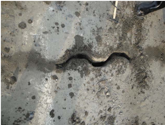
写真-9.143 ゴムジョイントのゴムの脱落 (A 1 橋台周辺)
