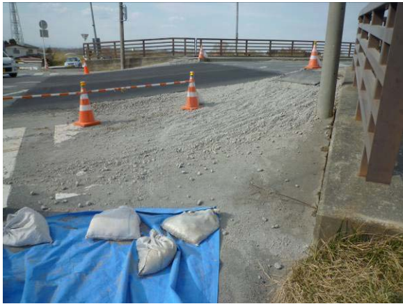
写真-9.155 橋台背面段差(右岸A1側)
