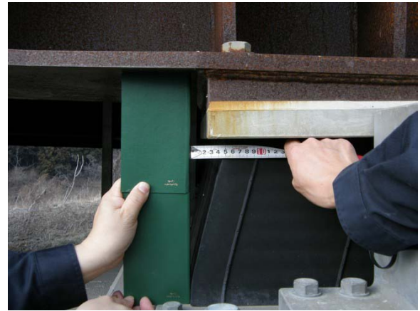
写真-9.85 ゴム支承のせん断変位
