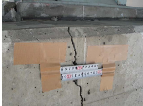
(b) ひび割れ
