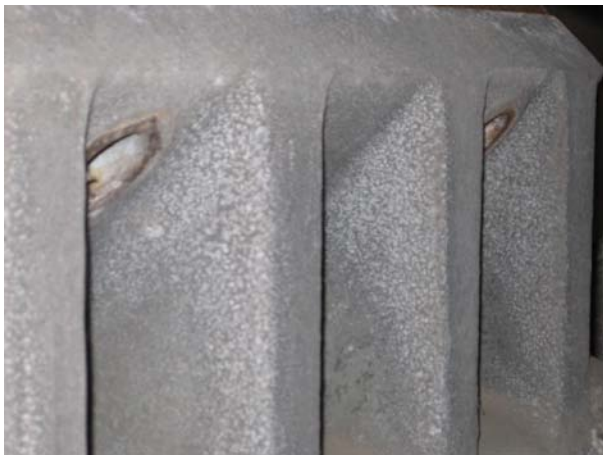
(e) 支承部(前面側)のボルト破断の状況
