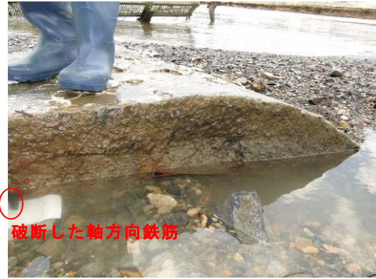
写真-9.115 P 3 橋脚の破壊面
