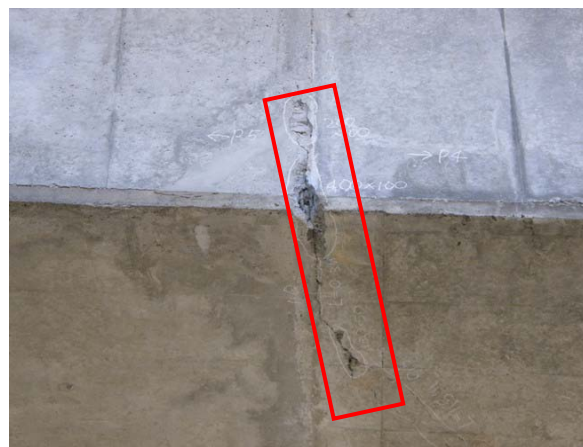
写真-9.16 箱桁の斜めひび割れ、欠け落ち
