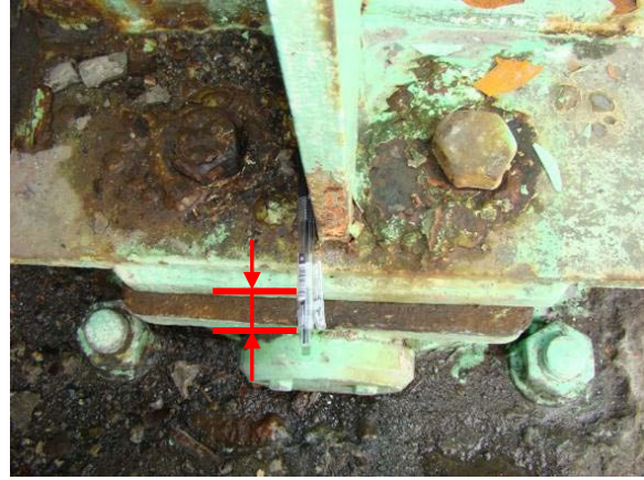
写真-9.50 支承ボルト腐食及び 支承横方向のズレ
