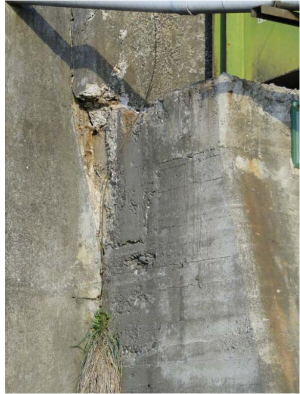
写真-9.103 A 1 橋台上流側ひび割れ部
