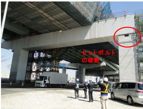
写真-9.68 P 5 6 橋脚：鋼横梁を支持する柱上のゴム支承セットボルトが破断
