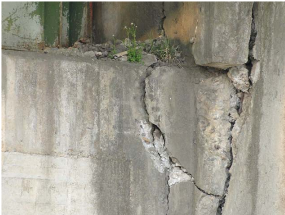
写真-9.104 A 1 橋台下流側ひび割れ部拡大
