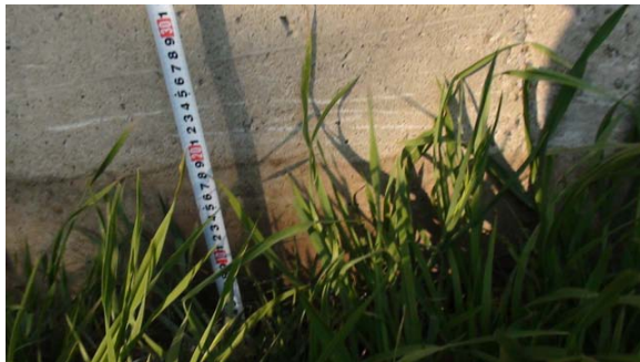
(b) A2 橋台周辺地盤((a)の四角部位置)の沈下量(約 20cm)
