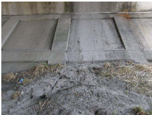
写真-9.154 A 1 橋台前面の地盤状況：液状化の影響か、地盤の乱れがみられる。
