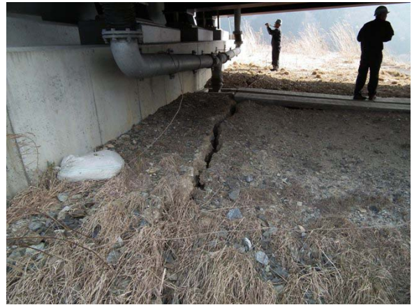
写真-9.83 橋台前面地盤のひび割れ
