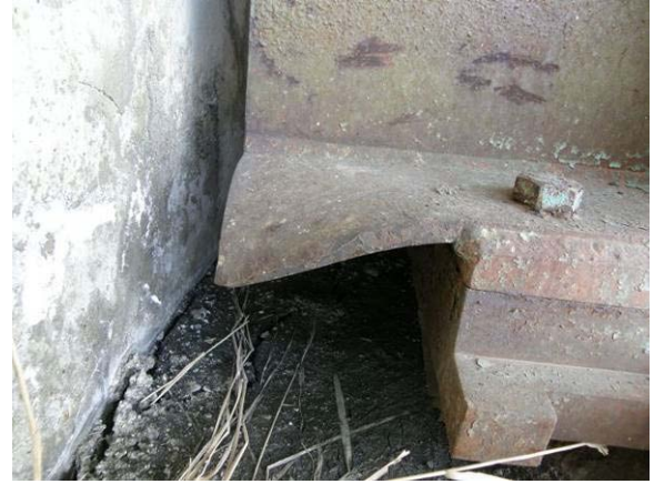
写真-9.171 A 2 橋台上G 1 桁端部の変 形
