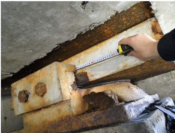
写真-9.13 A 2 橋台支承の水平移動の擦過痕（約5cm）
