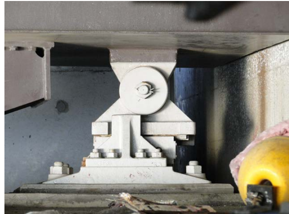
(k) 可動支承に生じた変状
