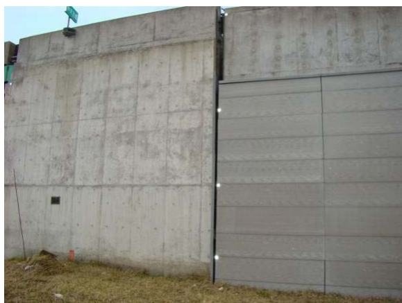
写真-9.55 A 2 橋台と背面盛土の遊間及び沈下
