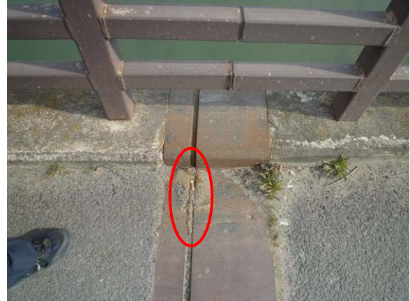
写真-9.167 伸縮装置路肩部(P 3)
