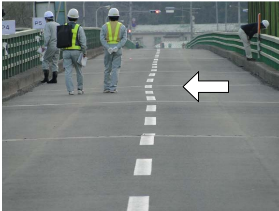
写真-9.94 P 4 直上付近の路面の状況 (A 1 橋台側から A 2 橋台側を望む)
