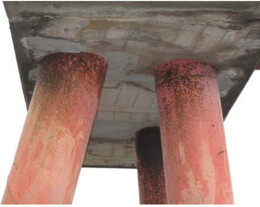
写真-9.62 上横梁の下面（補修痕有り）
