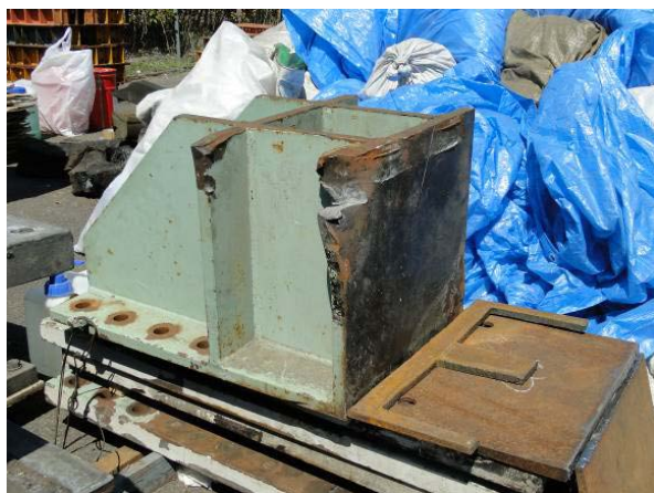
写真-9.74 破損したジョイントプロテクター
