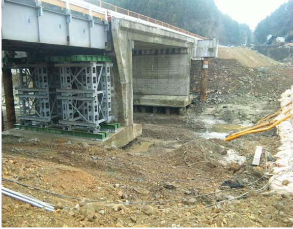
写真-9.138 基礎部の洗掘状況(4月9日 撮影 東北地方整備局提供)
