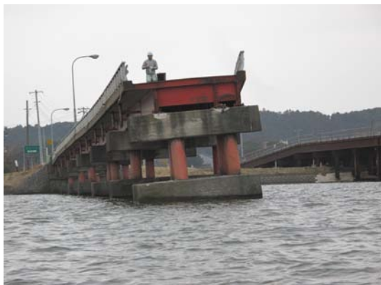
写真-9.60 落橋箇所の右岸側
