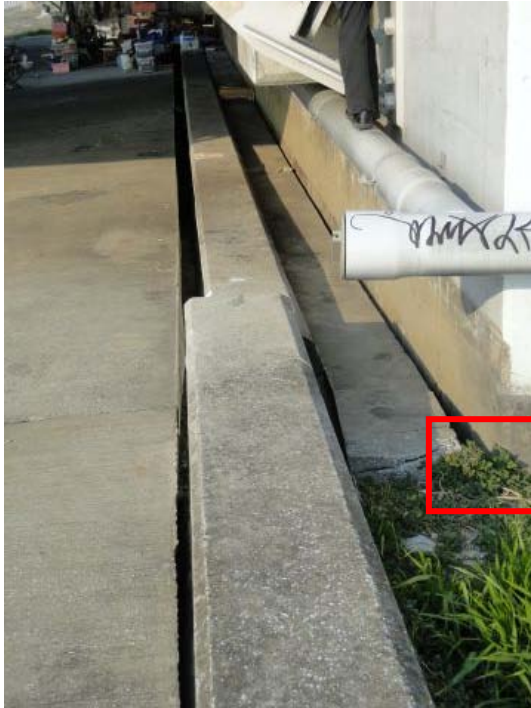
(g) 橋台前面・側面と周辺地盤の間に生じた隙間
