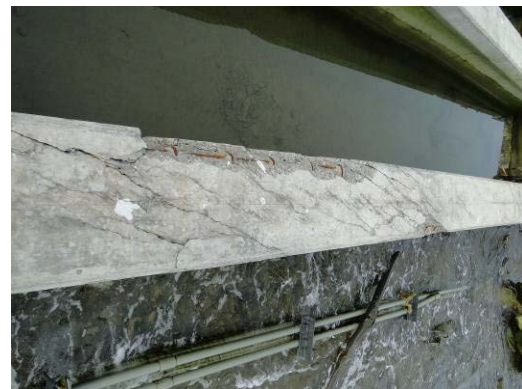
写真-9.128 桁のひび割れ状況
