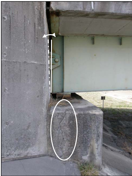
写真-9.157 A1橋台、桁端部の状況： 桁端部のつまり（回転）、 橋座部のひび割れ等が発生
