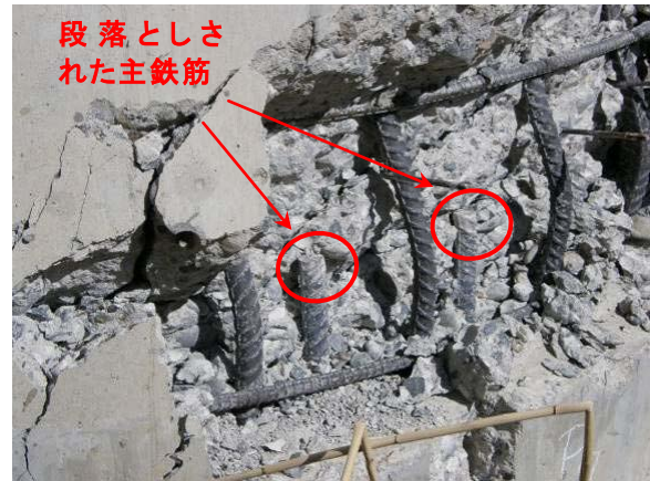
写真-9.6 P 7 橋脚段落し部の損傷状況 (A 2 側)
