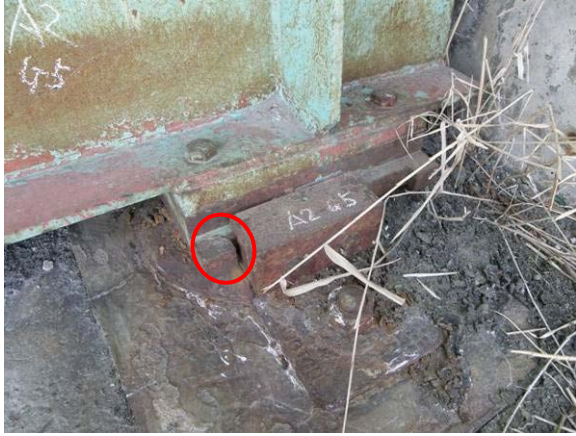
写真-9.170 A 2 橋台支承の状況：前側 サイドブロックとの間にす き間がある
