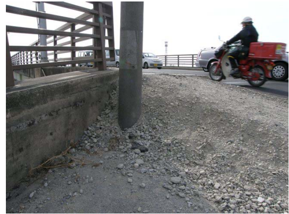
写真-9.156 橋台背面段差(左岸A2側)
