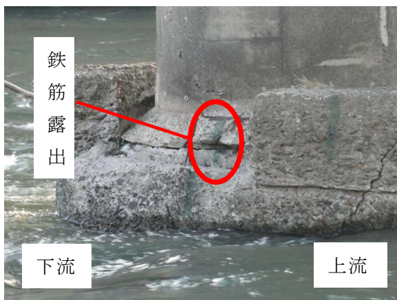
写真-9.92 P 4 橋脚のケーソン基礎の損傷状況
