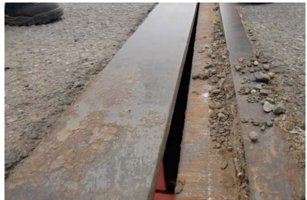
写真-9.61 遊間に生じた変位差
