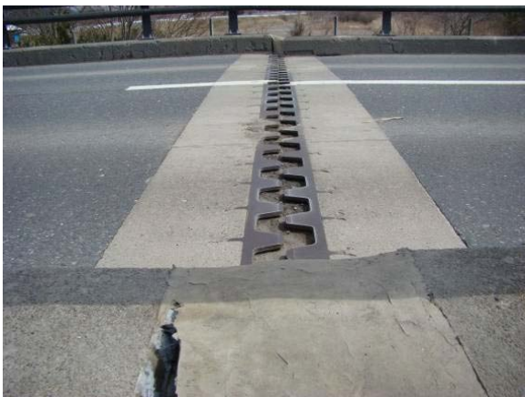
写真-9.53 伸縮装置の遊間異常
