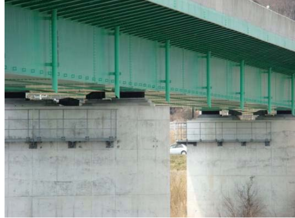
写真-9.58 P2橋脚のジョイント プロテクターの損傷
