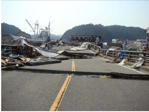
写真-9.129 流出している桁の状況 (P 4 ~ P 7 間)
