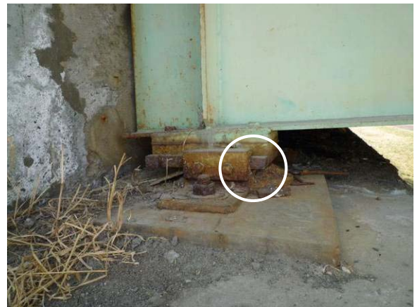
写真-9.159 A1橋台下流側（G5桁） 支承：サトブロックの遊間なし
