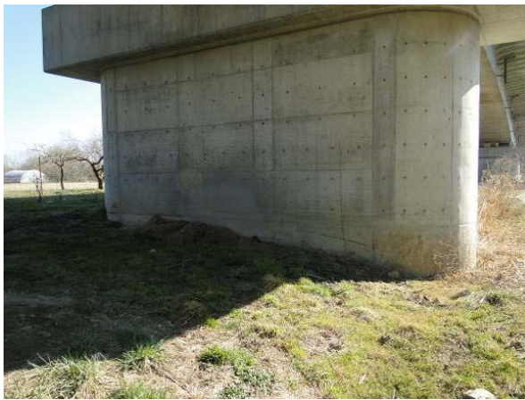
写真-9.7 P 7 橋脚段落し部の損傷状況 (A 1 側)
