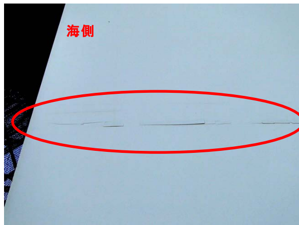
写真-9.75 P 5 2 橋脚中間部（海側）の塗膜割れ
