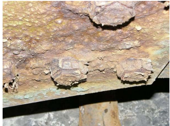
写真-9.163 主桁と横鋼接合部の腐食状況
