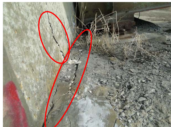
写真-9.169 A 2 橋台パラペット前面及 び橋座部のひび割れ等
