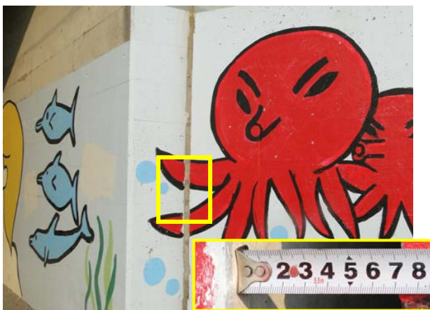
(c) 橋台躯体とそで擁壁との間に生じた隙間 拡大写真(たこの足の部分の隙間: 約7cm)
