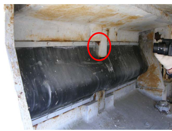
写真-9.10 P 5 橋脚上の支承：ローラーの ずれ、上沓側の爪の塗膜剥がれが確認
