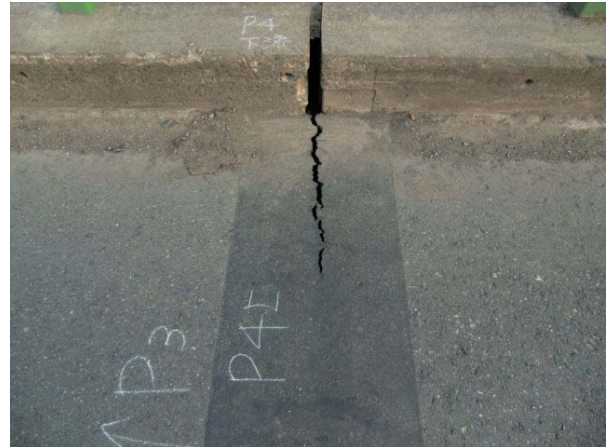
写真-9.95 P 4 橋台上の路面に生じたひび割れ
