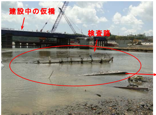
写真-9.114 流出した P 3 橋脚の状況
