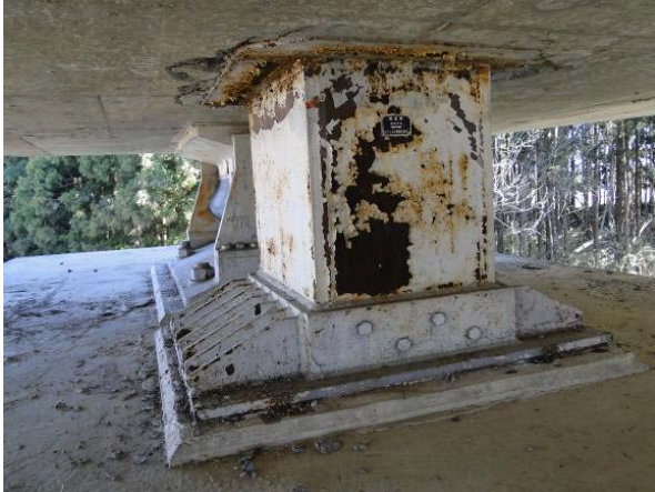
写真-9.11 P 5 橋脚上のストッパー（両方向固定）取付部のモルタル剥落
