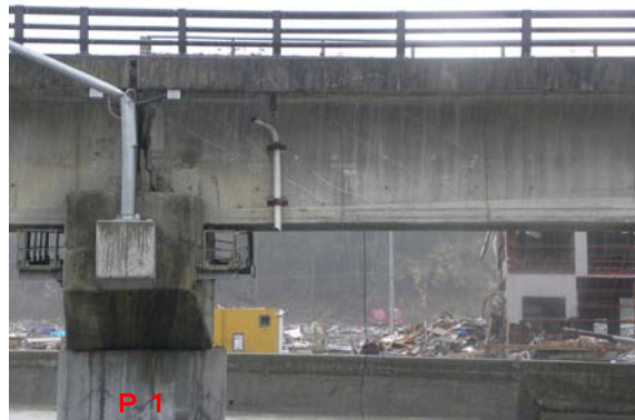
写真-9.133 斜めひび割れの発生状況 (P 1 ~ P 2 間 G 4 側)
