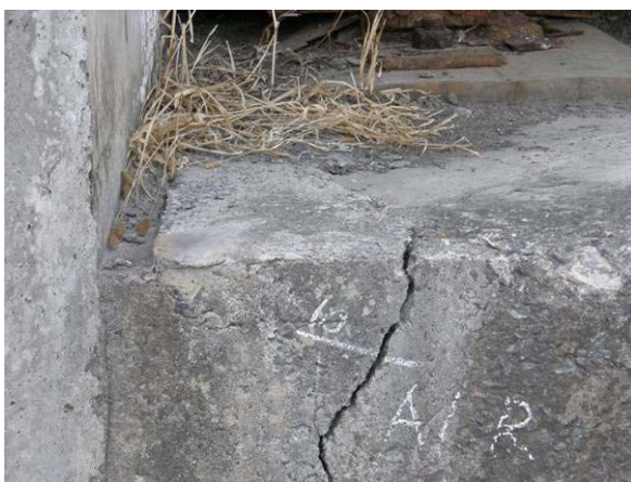
写真-9.160 A1橋台下流側橋座部（写 真-9.157の拡大）：G5桁支承の 後ろから側面にかけて10mmのひび 割れ、数mmの段差（前側が低い）。 既往の補修モルタル痕もみられる。
