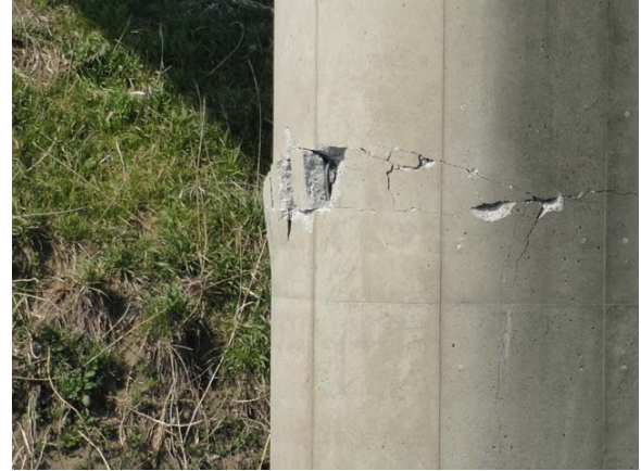
(b) コンクリートの曲げ損傷
