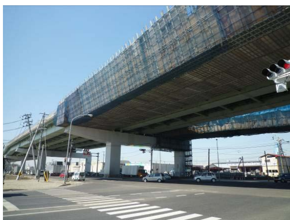
写真-9.64 P 5 6 側から見た P 5 5 橋脚等の状況
