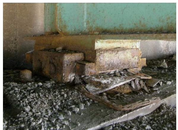
写真-9.161 A1橋台内桁（G2）支 承：著しい腐食と破損。擦 過痕や塗膜剥がれから、一 部の損壊は新しいものと推 定。
