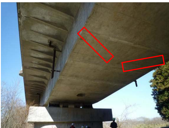
写真-9.15 箱桁の斜めひび割れ（底面）
