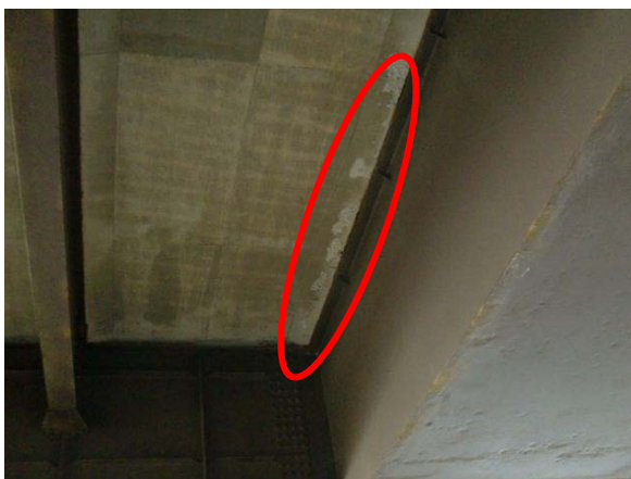
(i) 床板裏面にみられた剥離
