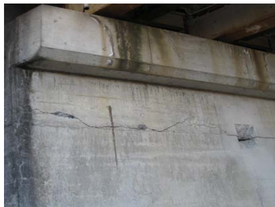
写真-9.27 A 1 橋台前面のひび割れ
