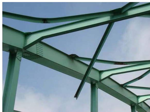
写真-9.46 上横構座屈及びガセット部破断
