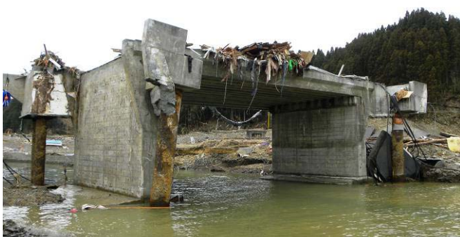
写真-9.136 下流側歩道部における桁の流出と歩道部橋台基礎(鋼管杭)の傾斜
