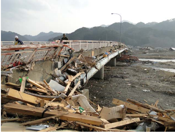
写真-9.141 けたへの漂流物の堆積 (A 2 橋台周辺、陸側)
