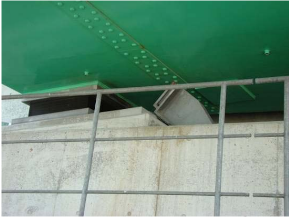
写真-9.57 A1橋脚のジョイント プロテクターの損傷
