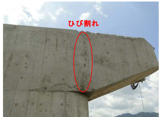
写真-9.119 P 5 橋脚の張出し部のひび割れ
