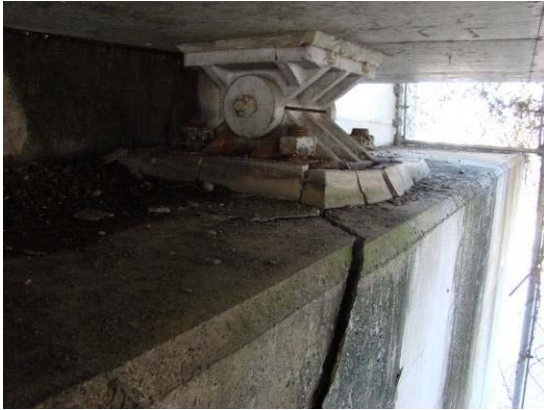
写真-9.32 橋座のせん断破壊 (上り線A 1橋台)
