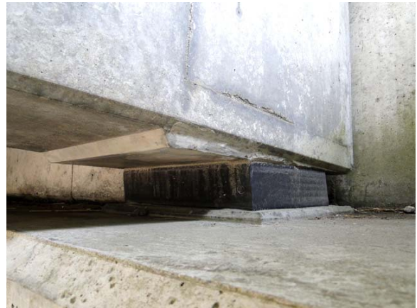
写真-9.144 A 1 橋台のゴム支承の軽微な 変形
