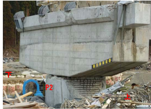
写真-9.124 P 2 橋脚の損傷状況
