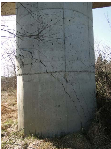
写真-9.3 P8橋脚段落し部の損傷状況 (側面)
