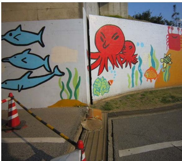
(b) 橋台躯体とそで擁壁との間に生じた隙間
