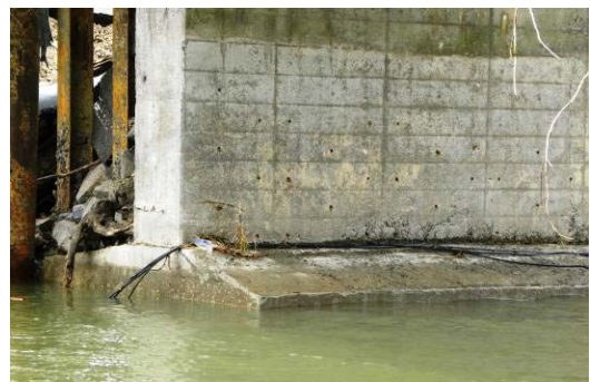
写真-9.137 橋台フーチングの露出状況(3月15日撮影)
