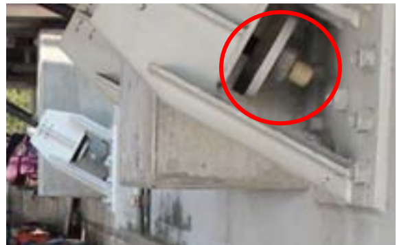
(l) 落橋防止構造のケーブル端部のゆるみ
