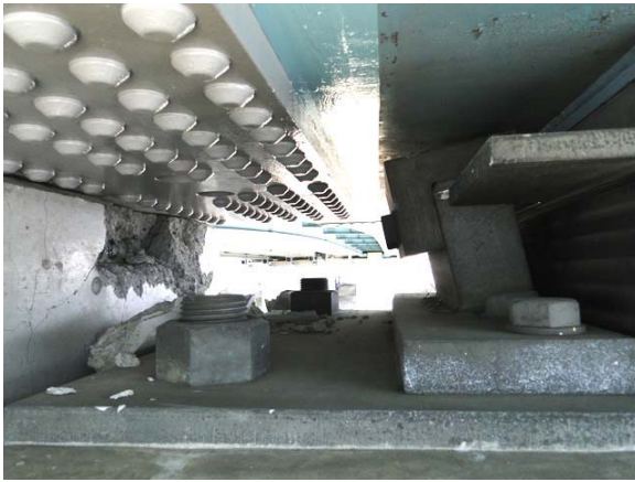
写真-9.42 支承部のサイドブロックの損傷
