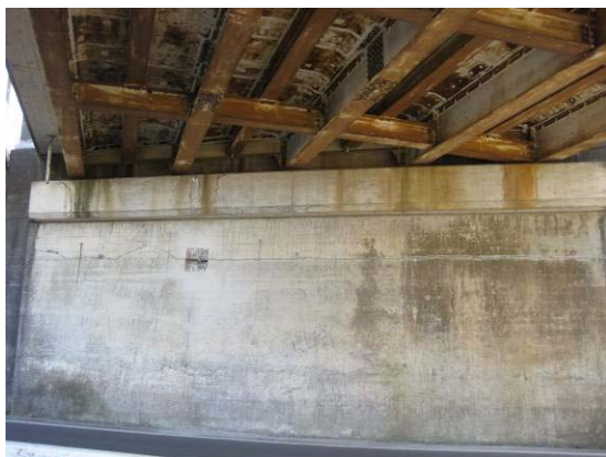
写真-9.26 A 1 橋台前面のひび割れ
