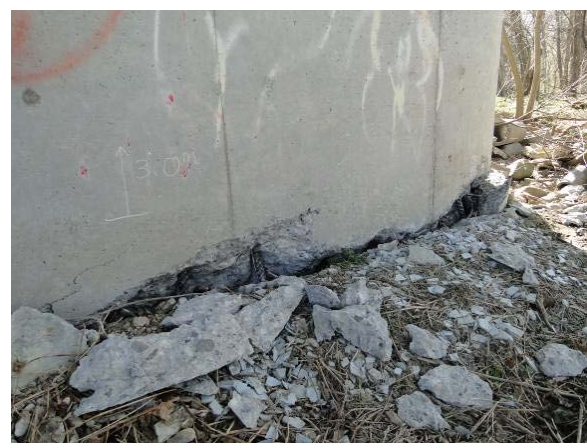
写真-9.8 P 5 橋脚段落し部の損傷状況 (A 2 側)
