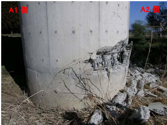
写真-9.5 P 7 橋脚段落し部の損傷状況 (側面)
