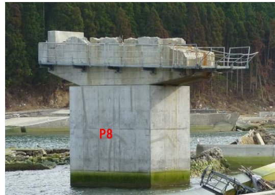
写真-9.126 P 8 橋脚の損傷状況
