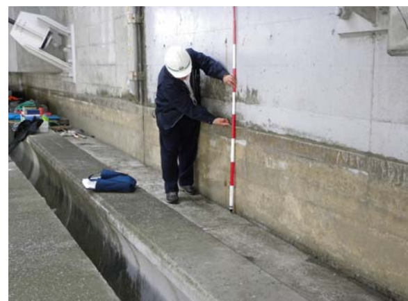
(f) 護岸の沈下(約70cm)
