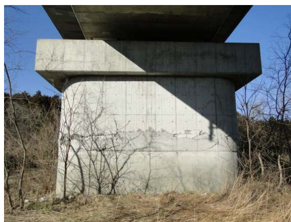
写真-9.4 P8橋脚段落し部の損傷状況 (A1側)
