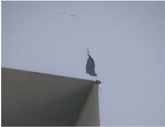
写真-9.78 P 5 4 橋脚山側隅角部の塗膜剥がれ
