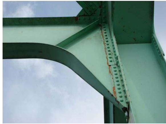
写真-9.52 橋門構の塗膜割れ
