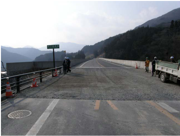
写真-9.84 橋台背面の沈下と応急復旧状況
