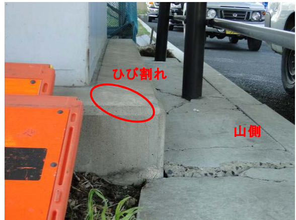
写真-9.81 P 5 2 橋脚の山側の基部：根巻きコンクリートと周辺コンクリートにひび割れ
