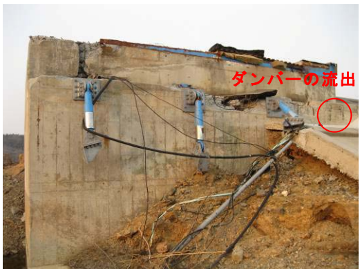
写真-9.118 A 2 橋台のダンパーの損傷状況
