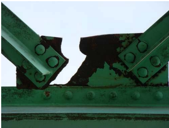
写真-9.45 ガセット部の破断
