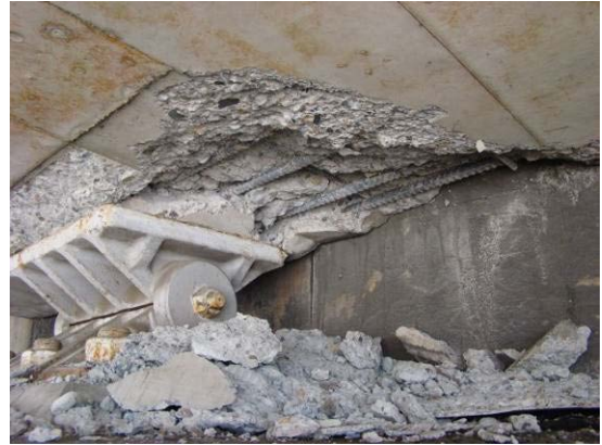
写真-9.33 支承が取り付け上部構造側の の損傷 (下り線A 2橋台)
