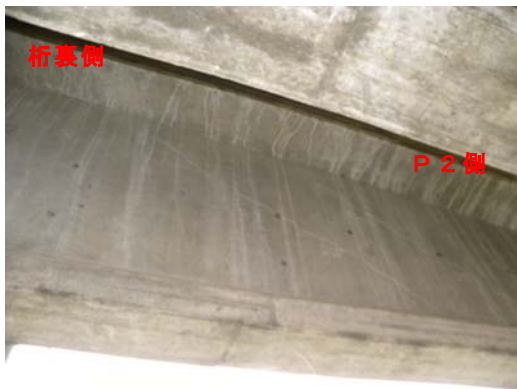
写真-9.132 斜めひび割れの発生状況 (P 1 ~ P 2 間 G 1 側)
