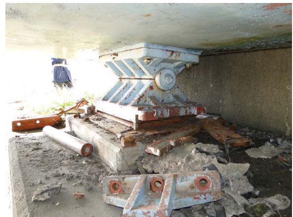
写真-9.22 A 2 橋台の可動支承の損傷
