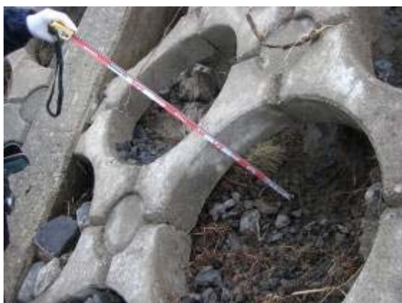
写真-10.49 のり枠背後の土砂流出 による隙間
