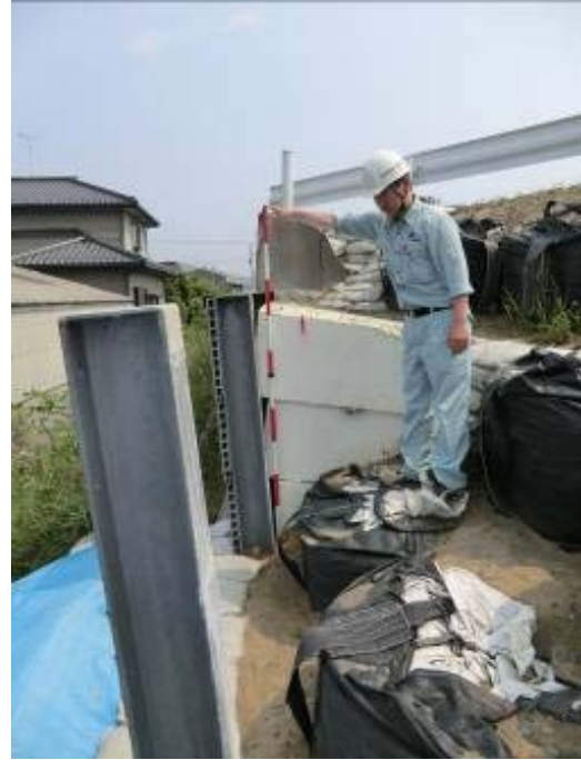
写真-10.31 EPS部の状況 （支柱は前面に傾斜するとともに、EPS自体は盛土の沈下に伴い後方に傾斜している）
