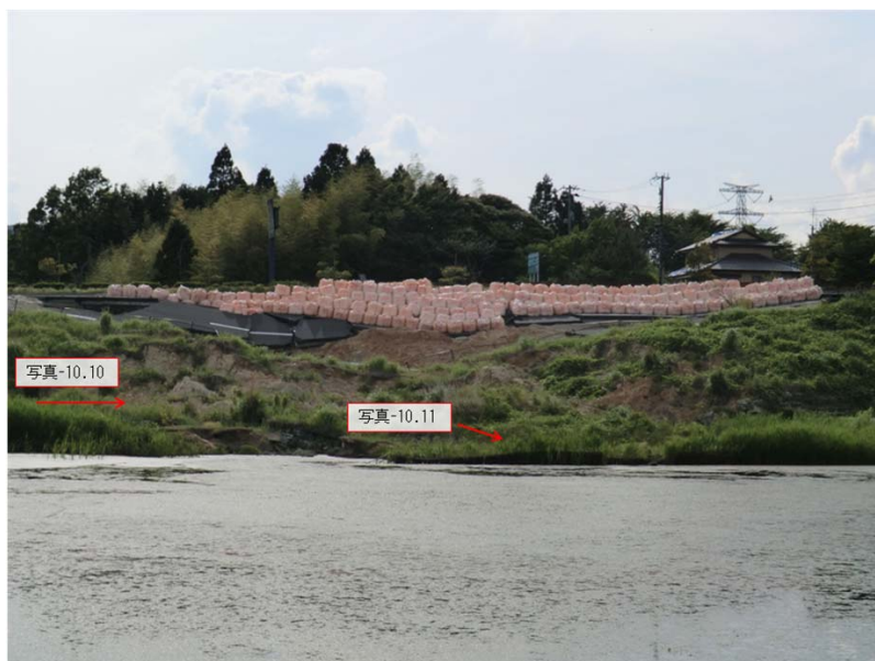
写真-10.9 崩壊箇所（全景）
