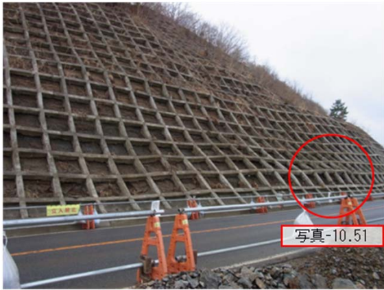
写真-10.50 吹付けのり枠工の被災箇所 （全景）
