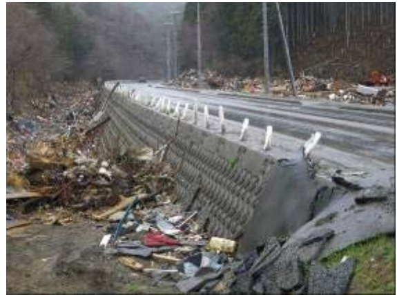
写真-10.59 盛土側面のブロック積擁壁 (南三陸町上大坊) (津波が道路面(盛土上面)を越えたが、擁壁には被災がなかった。)
