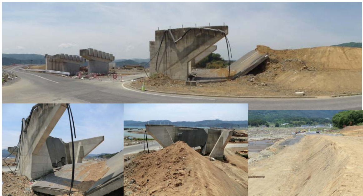
写真-10.57 津波により橋梁上部工とともに橋台背面盛土が流出 (陸前高田市高田町 沼田跨線橋)
