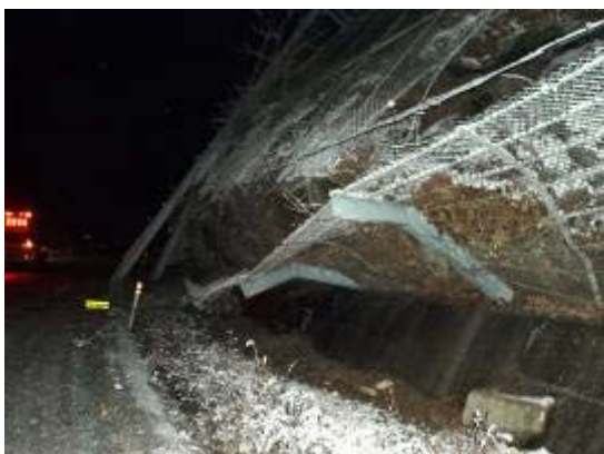
写真-10.33 本震から10時間後の状況
