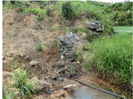
写真-10.22 のり尻下部のしみだし (ふとんかご設置位置を境にしみだしが 確認される)
