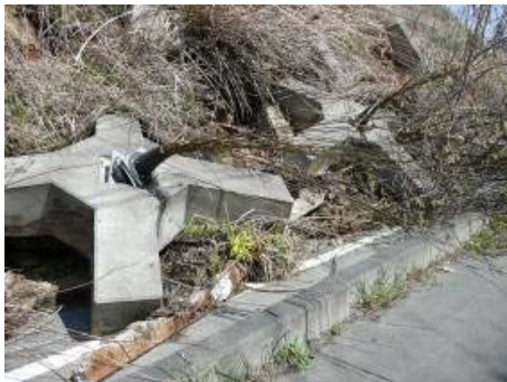
写真-10.43 被災したグラウンド アンカー工
