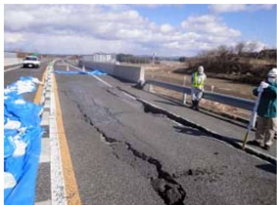
写真-10.7 盛土のすべりによる路面の亀裂
