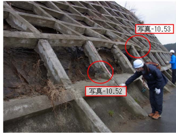
写真-10.51 のり枠の損傷箇所 （内部の吹付けモルタルは、一部残ったがほとんど部分で金網ごと流亡した）
