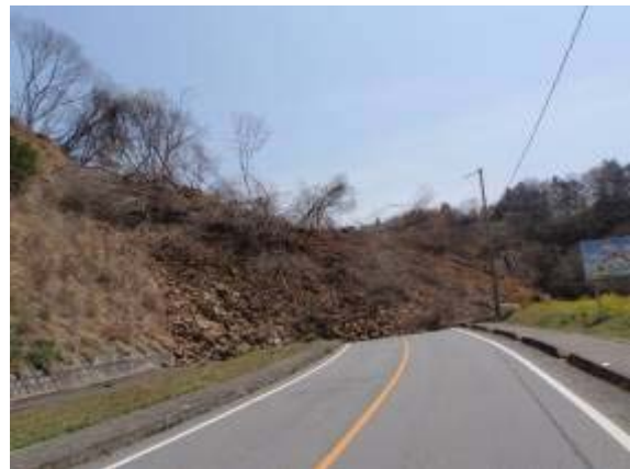
写真-10.44 右側部末端の状況
