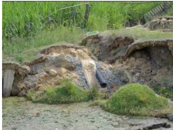
写真-10.23 のり尻下部の公園内の整地箇所の被災状況 (碎石およびポリエチレン管による排水工が確認される)
