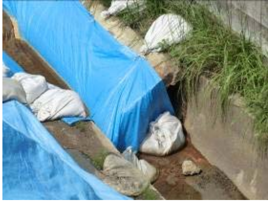
写真-10.30 側溝側壁の転倒 (変状に伴い側溝が押され、盛土側の側壁が転倒しているが、前面のブロック壁には特に変状は見られない)
