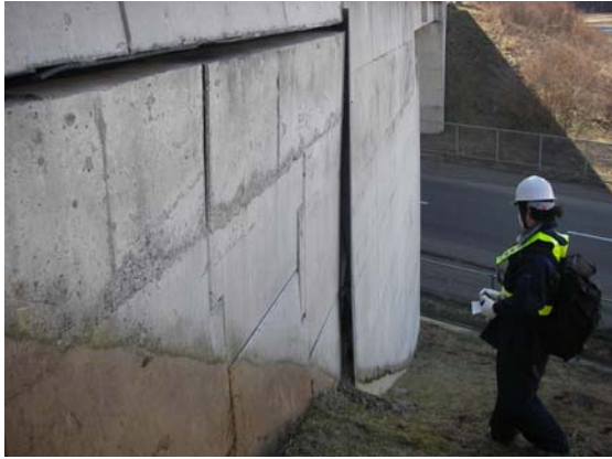
写真-10.8 補強土壁の変状
