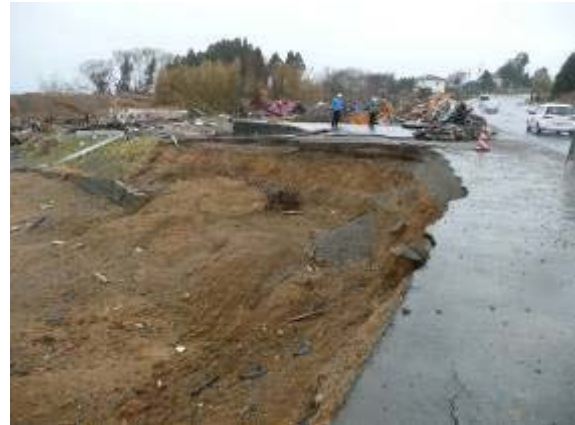
写真-10.56 津波による盛土の被災 (気仙沼市小金沢)
