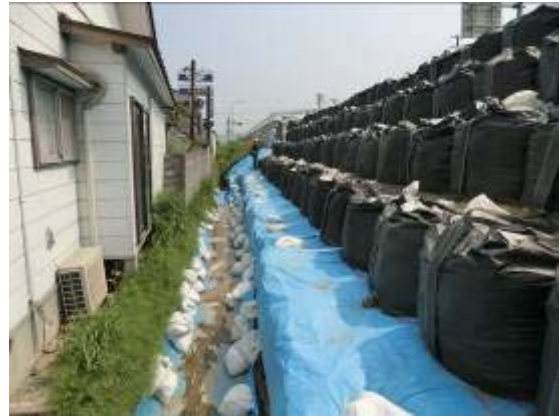
写真-10.29 のり尻部の状況 （近傍の家屋には変状は見られない）
