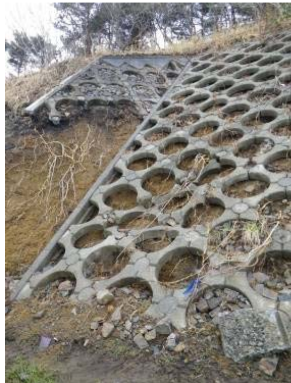
写真-10.48 プレキャストのり枠 の被災状況 (のり枠の一部・枠内のぐり石が流失)
