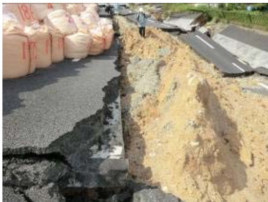
写真-10.19 旧コンクリート舗装盤境 (拡幅盛土部が大きく崩落)
