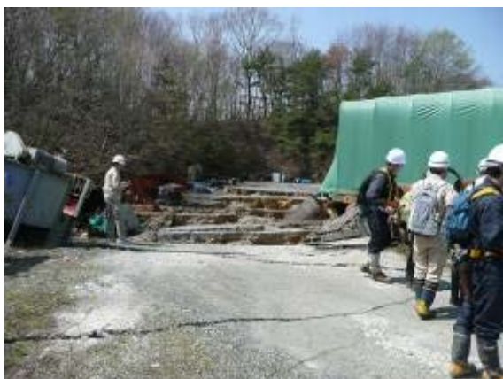
写真-10.45 地すべり地内の亀裂・段差
