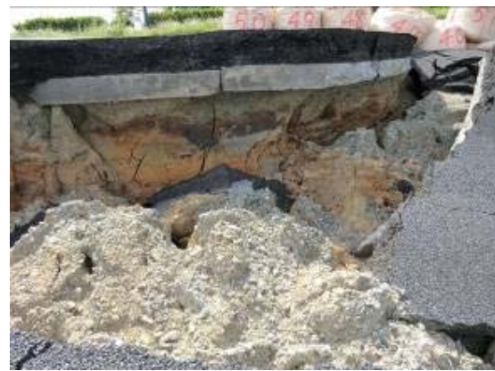
写真-10.20 切土部の舗装盤下の基岩 (盛土部の喪失により切盛り境で旧コン クリート舗装盤が破断している)
