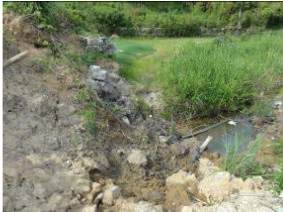
写真-10.21 崩壊下部の側方の状況 (公園内の周囲ののり尻部がふとんかご で補強されている)
