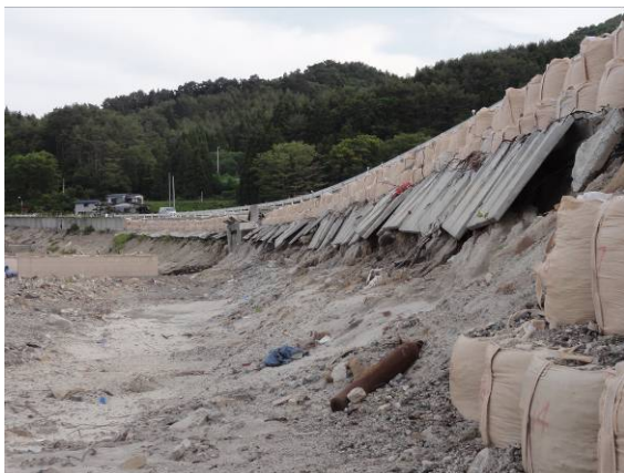
写真-10.60 L型擁壁の倒壊 (大槌町浪板吉里吉里) (津波がL型擁壁の上端を越え、擁壁が倒壊した)
