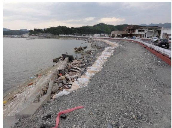
写真-10.61 擁壁の倒壊 (山田町山田) (津波が擁壁の上端を越え、擁壁が倒壊した)
