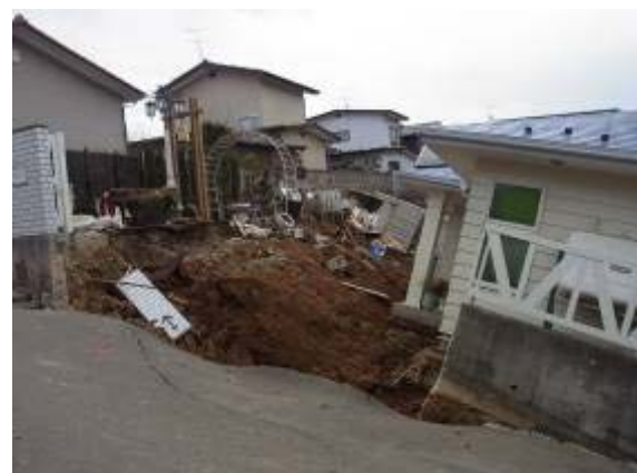
写真-10.3 崩壊頭部の状況
