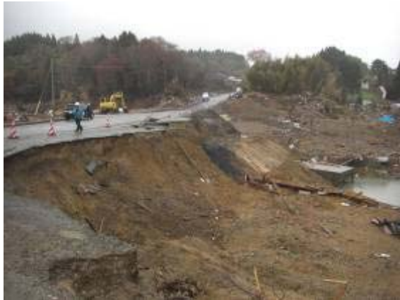
写真-10.55 津波による盛土の被災 (気仙沼市小金沢)
