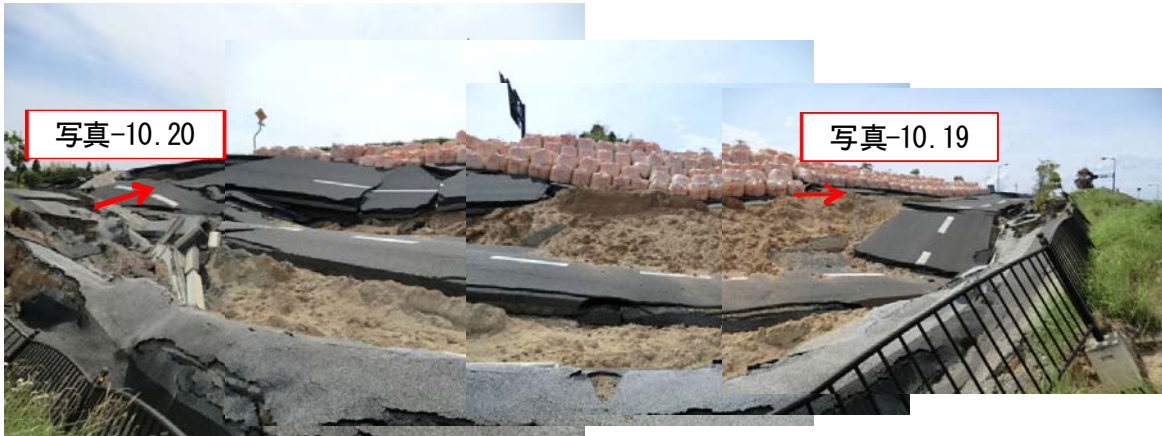
写真-10.18 崩落した路面部の状況
