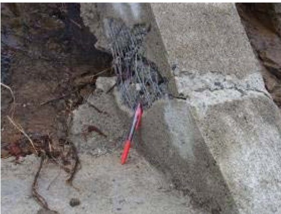
写真-10.52 のり枠下部の損傷 （金網型枠内のモルタルも破砕）
