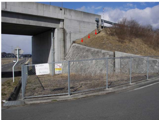
写真-10.6 盛土のすべり
