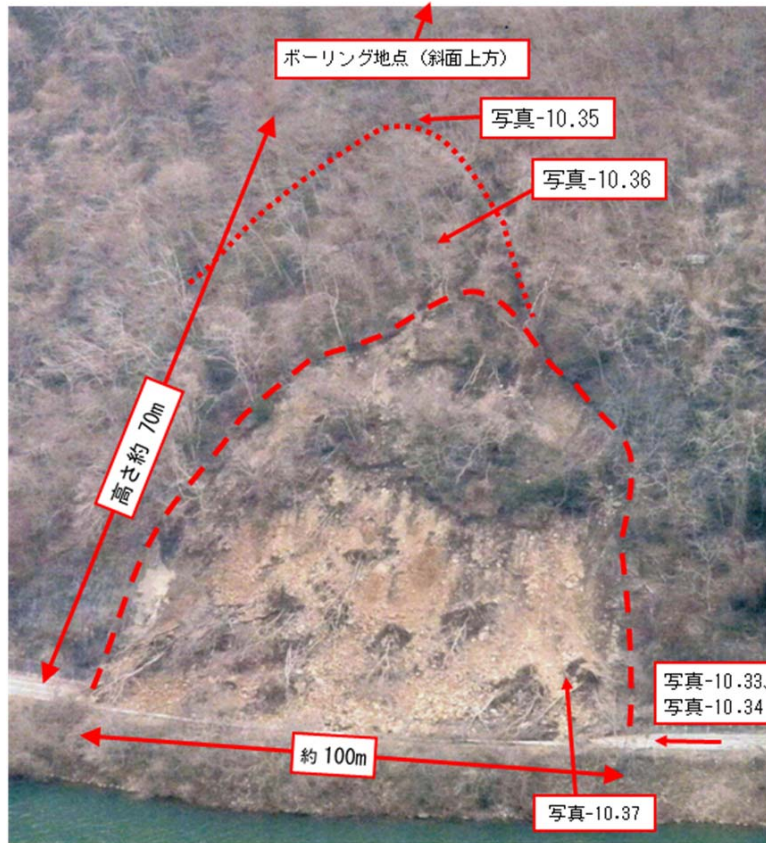
写真-10.32 斜面崩壊による国道の閉塞（全景）
