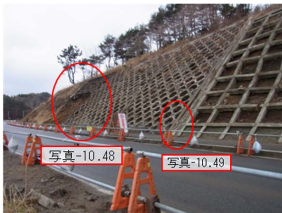
写真-10.47 プレキャストのり枠 の被災箇所
