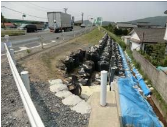
写真-10.28 被災箇所の状況（全景） （EPSの側壁パネルの柱が2本残されているが、前傾が見られる。）
