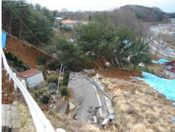
写真-10.4 崩壊中央部の状況
