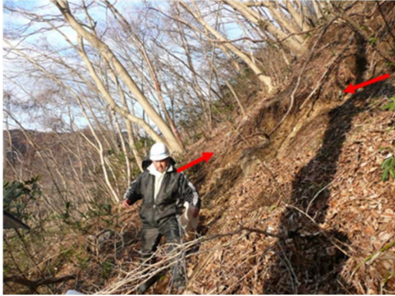
写真-10.35 上部斜面に生じた滑落崖 (矢印間)
