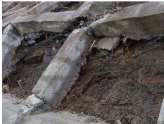
写真-10.53 のり枠の交差部の損傷 （金網型枠が破断し補強筋と枠も分離）
