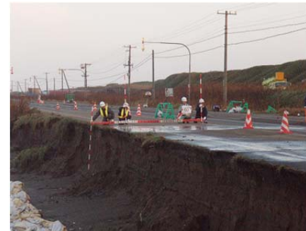
(b) 被災事例2 (B地区)
