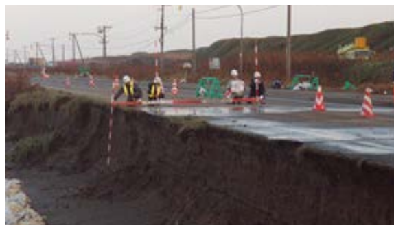
図-10 高波により海岸道路の盛土が侵食された様子（猿払海岸、北海道開発局稚内開発建設部提供）
