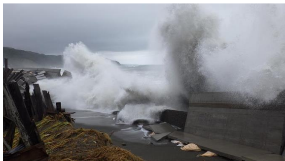
図-3 2015年8月のうねり性波浪により倒壊した新ひだか町静内の海岸護岸の様子（寒地土木研究所撮影）
