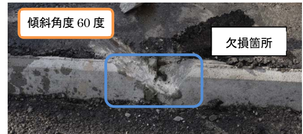
図-17 縁石の損傷状況（ホイールローダ）
