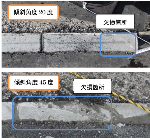
図-18 縁石の損傷状況（モーターグレーダ）
