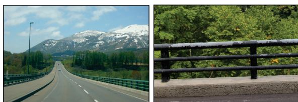
写真-5 左：緑系塗装が採用された事例 右：塗膜が剥がれた事例
