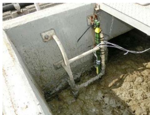
図-3 液温センサー設置状況
