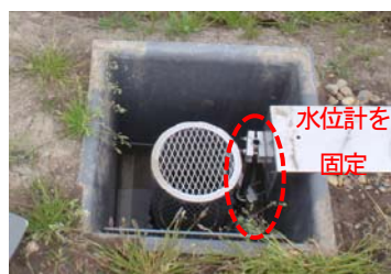
図-3 集中管理孔に設置した水位計 (円筒型メッシュスクリーンの下に暗渠管がある。)
