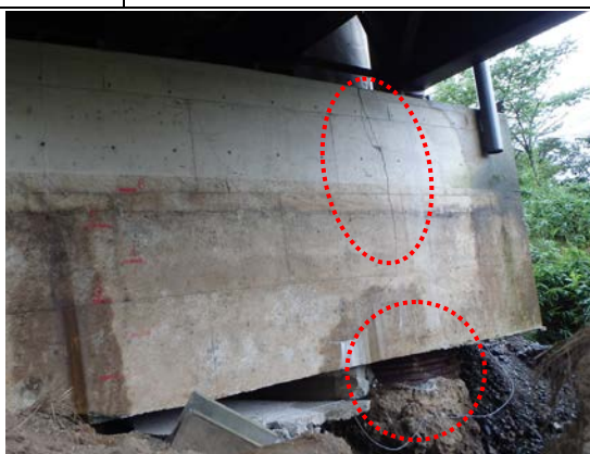
写真-2.2.2 深礎杭の杭頭部露出及び直上たて壁の鉛直方向ひび割れ
