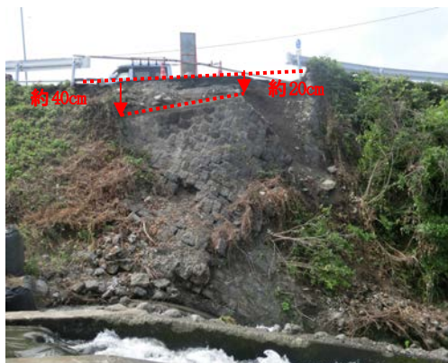
写真-2.2.4 左岸側橋台の沈下状況
