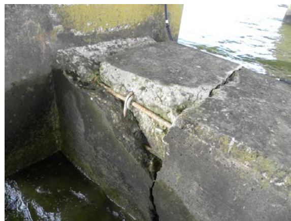
写真-2.1.1 2柱式ラーメン橋脚下層梁の損傷
