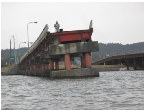
写真-2.1.2 落橋箇所の右岸側橋脚の傾き
