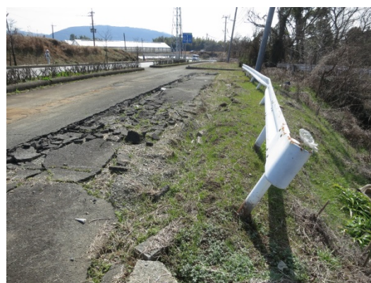
図-1 盛土変状箇所
