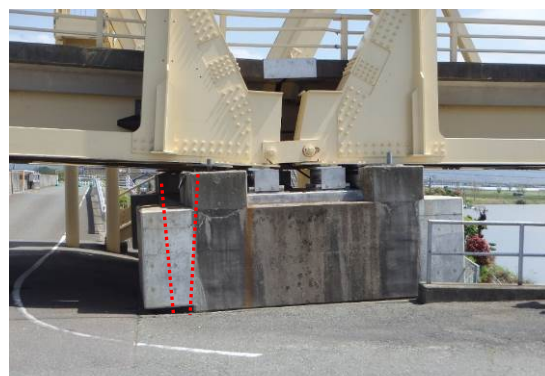
写真-2.2.3 P3橋脚・基礎の沈下と傾斜
