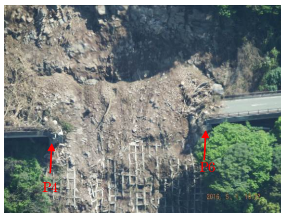
写真-2.2.6 上方斜面の崩壊と橋梁被災状況 (P4橋脚～P6橋脚間)
