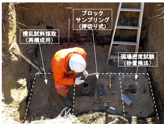
図-4.2 箇所 No.2のブロックサンプリング状況 (同様の作業を隣接した3箇所で行った)
