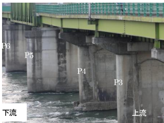
写真-2.1.5 P4橋脚の傾斜状況
