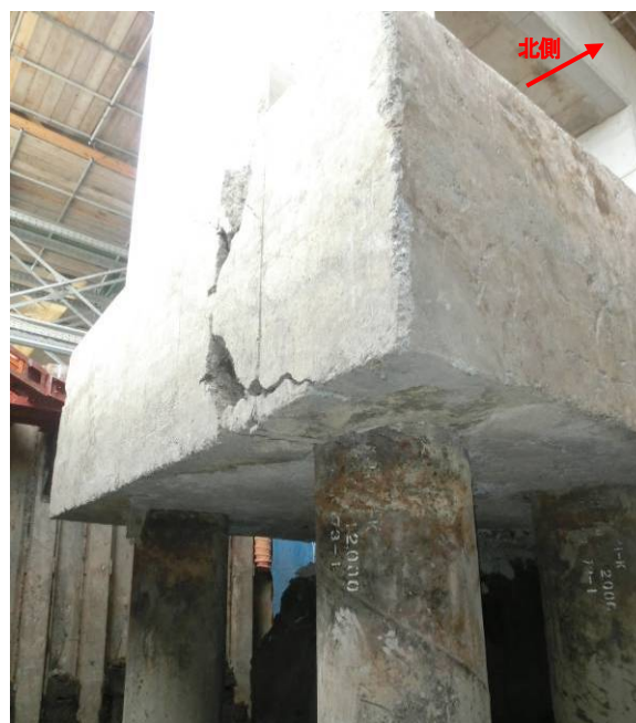
写真-2.2.1 フーチングのひび割れ(全景) (下り線P11橋脚)
