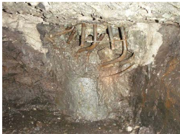
写真-2.1.3 A1橋台杭頭部の損傷状況
