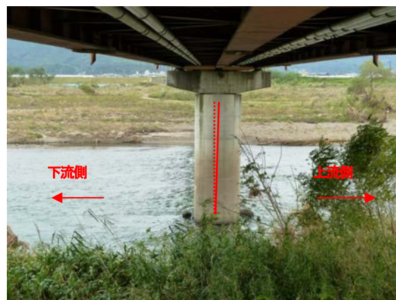
写真-2.1.4 P1橋脚の傾斜状況
