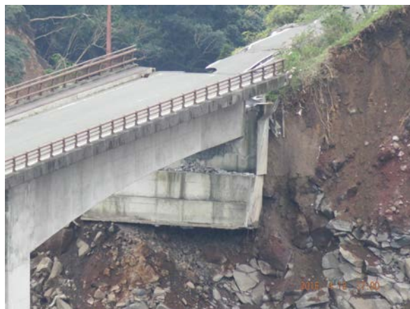
写真-2.2.5 A1橋台の損傷、基礎直下の土砂流出
