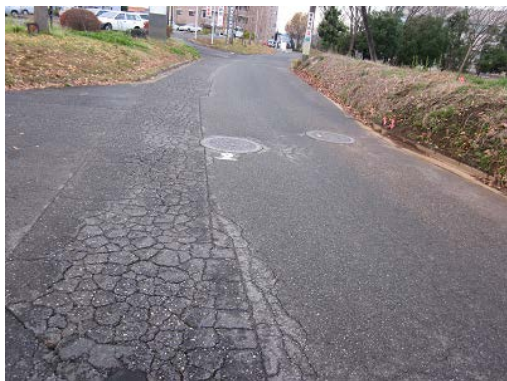
写真-3.1 占用工事施工箇所の破損状況
