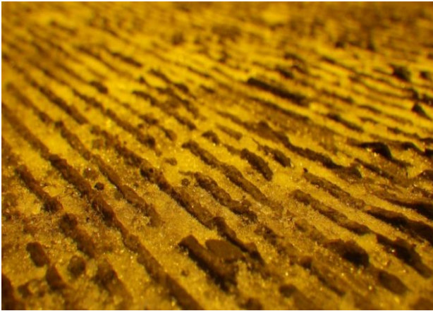
写真-14 冬期のDG対策路面の状況
