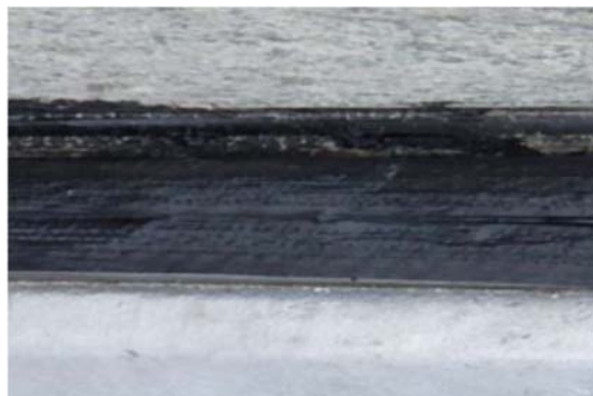
写真-5.5 ゴム袋体切断面（防水保護材なし）
