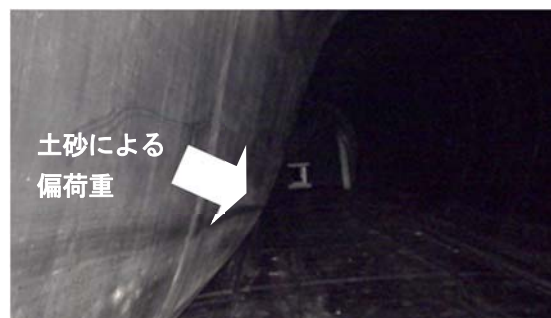
写真-5.3 流入土砂堆積による変形（堰内部）
