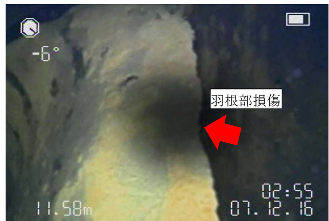
写真-2 内視鏡写真による羽根部の損傷状況
