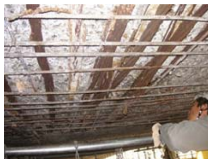
写真-1 既設 PC 橋における PC 鋼材の腐食・破断の事例
