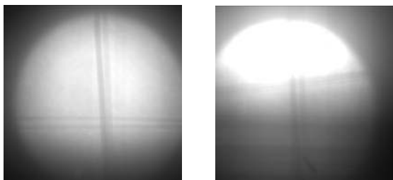
図-5 ウェブの撮影画像 図-6 下フランジの撮影画像
