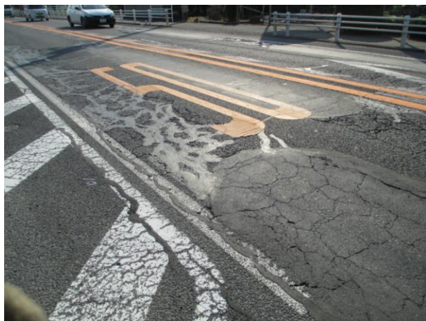
写真 2-1 修繕工事現場の路面状況
