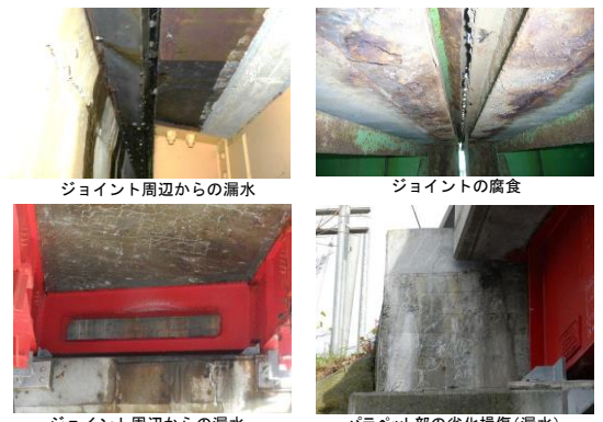
図-12 劣化損傷状況（腐食と漏水）
