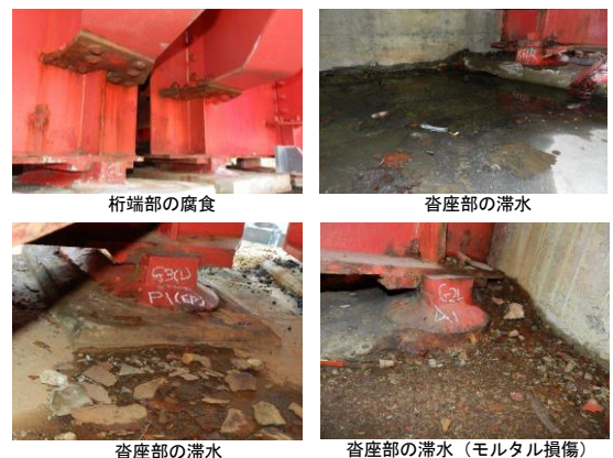
図-13 劣化損傷状況（滞水）
