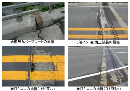
図-11 劣化損傷状況（周辺の損傷）
