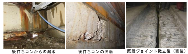
図-26 後打ちコンクリートの不具合
