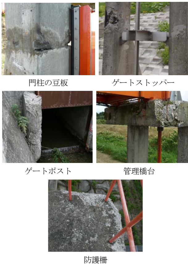
図-1 樋門ゲートの開閉に影響する可能性がある 樋門コンクリートの凍害劣化事例
