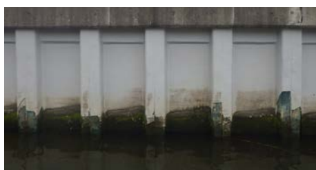
写真-1 特殊堤の補修後の再劣化状況
