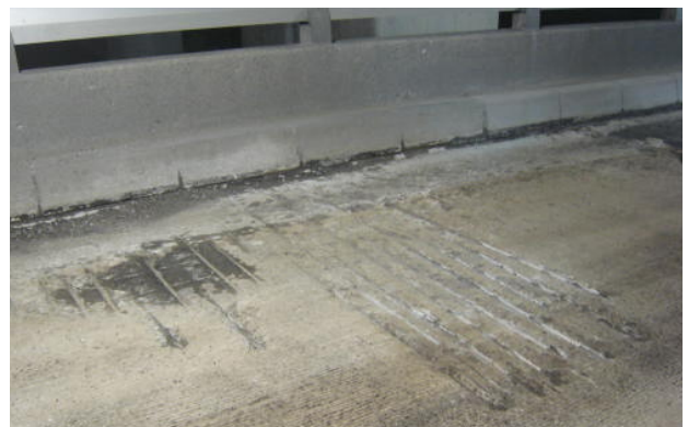
写真-1 舗装端部からの水分の浸入によるRC床版の損傷例
