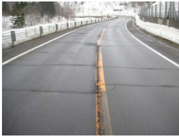
写真-1 低温ひび割れ
