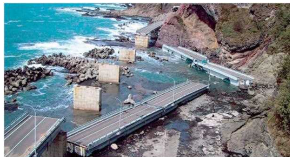
図-1 2004年8月の台風18号による神恵内村大森大橋落橋の様子（寒地土木研究所HP、平成16年台風18号による大森大橋被害調査より）
