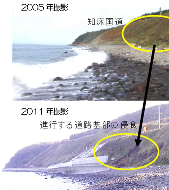
図-18 波浪による道路下斜面の侵食の様子（斜里郡斜里町、国道 334 号、北海道開発局道路維持課提供）
