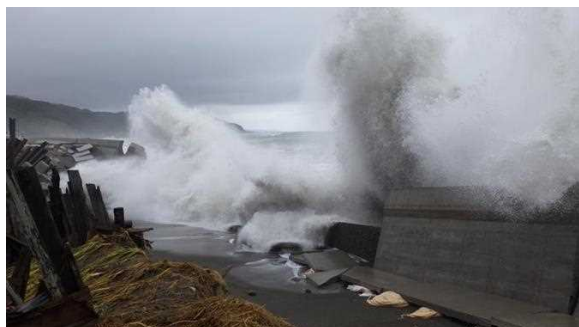
図-3 2015年8月のうねり性波浪により倒壊した新ひだか町静内の海岸護岸の様子（寒地土木研究所撮影）
