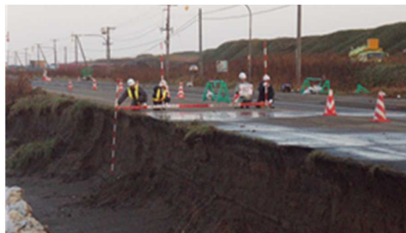
図-10 高波により海岸道路の盛土が侵食された様子（猿払海岸、北海道開発局稚内開発建設部提供）
