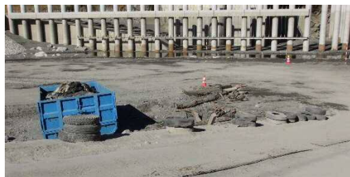
図-4 堆砂中に含まれていた流木等の状況
