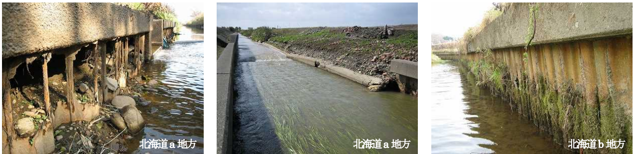
図-6 北海道内における農業用排水路を構成する鋼矢板の腐食
