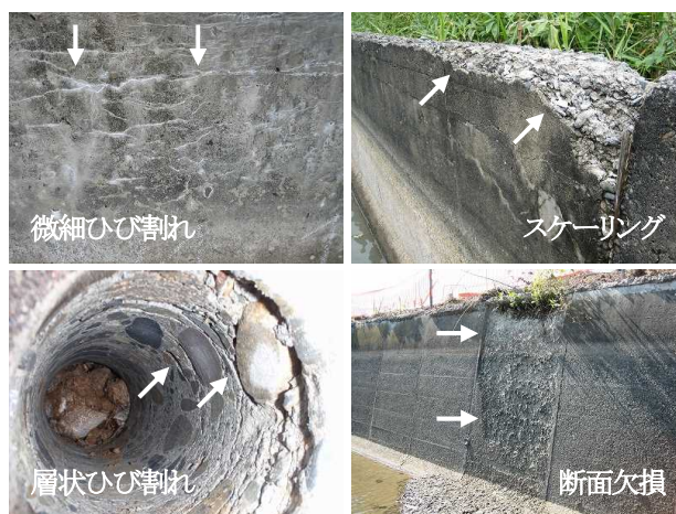
図-15 開水路に発生した凍害劣化による代表的な変状
