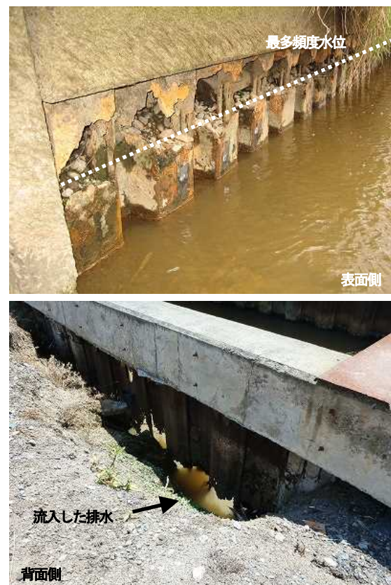
図-8 鋼矢板の腐食の代表的な現況
