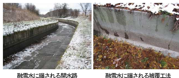
図-29 積雪寒冷地に位置するコンクリート開水路の非灌漑期の状況
