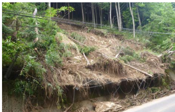
写真-1 表層崩壊の事例
