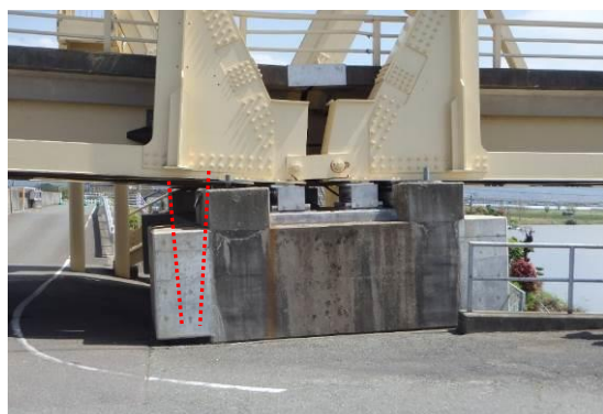
写真-2.2.3 P3橋脚・基礎の沈下と傾斜
