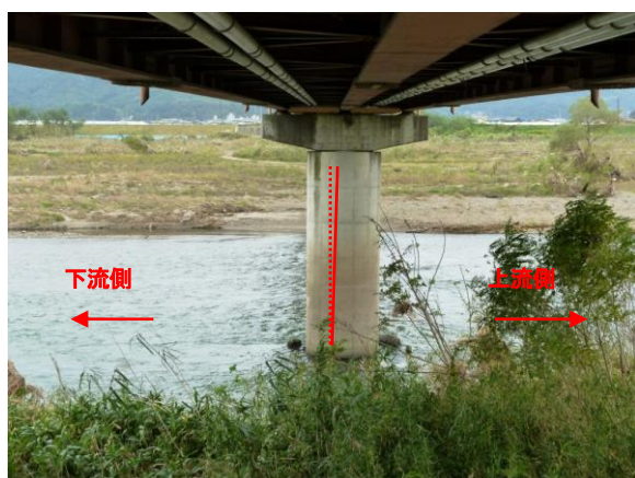
写真-2.1.4 P1橋脚の傾斜状況
