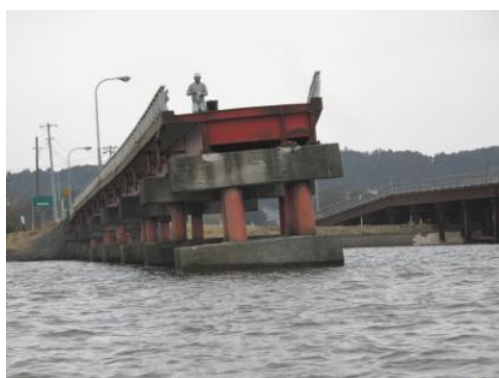
写真-2.1.2 落橋箇所の右岸側橋脚の傾き
