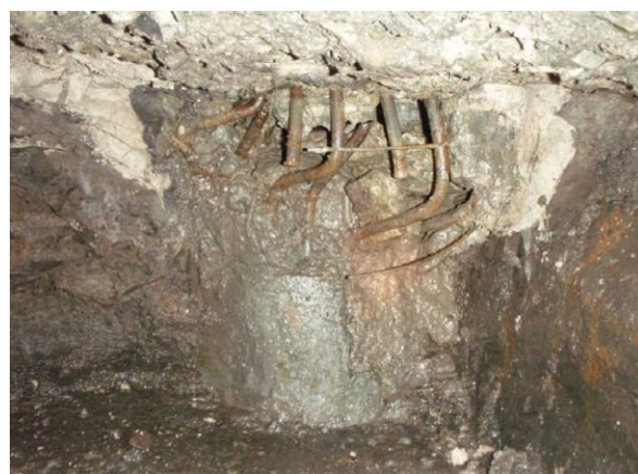
写真-2.1.3 A1橋台杭頭部の損傷状況
