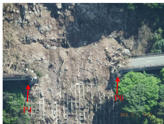
写真-2.2.6 上方斜面の崩壊と橋梁被災状況 (P4橋脚～P6橋脚間)
