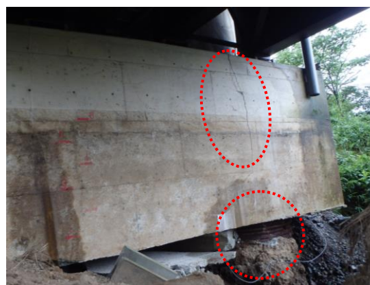
写真-2.2.2 深礎杭の杭頭部露出及び直上たて壁の鉛直方向ひび割れ
