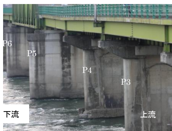
写真-2.1.5 P4橋脚の傾斜状況
