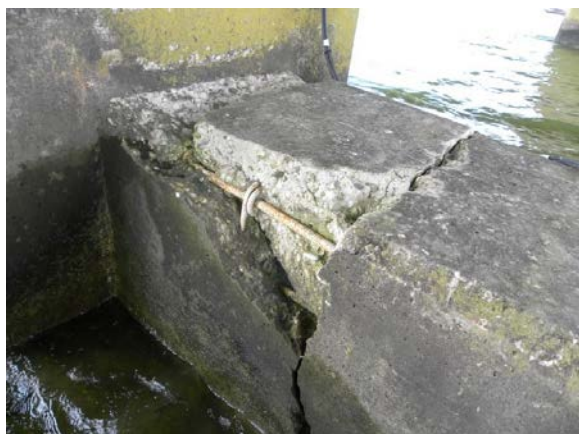
写真-2.1.1 2柱式ラーメン橋脚下層梁の損傷
