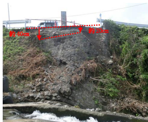
写真-2.2.4 左岸側橋台の沈下状況
