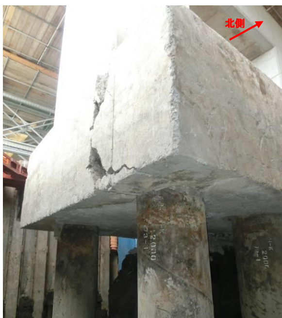
写真-2.2.1 フーチングのひび割れ（全景） （下り線P11橋脚）
