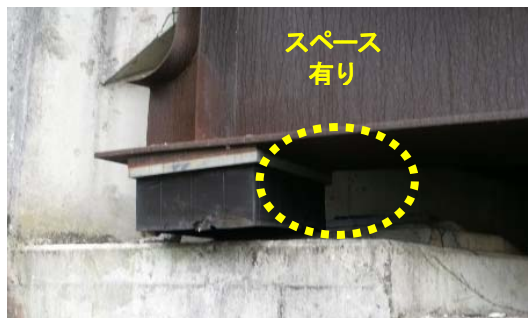
図-11 ゴム本体下端と下鋼板の接合面の被災事例
