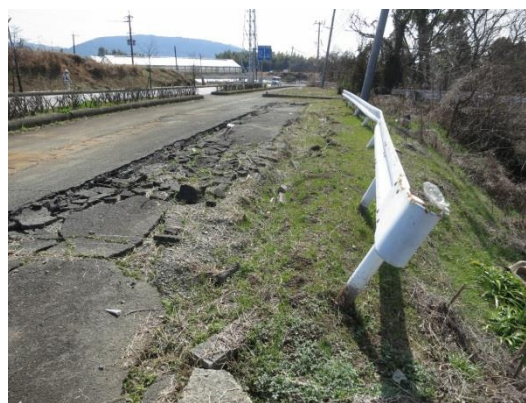
図-1 盛土変状箇所
