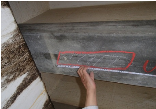
写真-4.1 被覆モルタル浮き部
