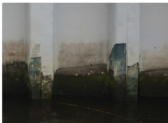
写真-2.4 保護モルタル剥落状況
