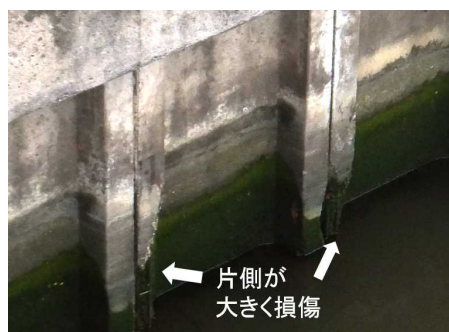
写真-2.2 矢板凸部の対策前の損傷状況
