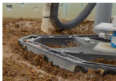
写真-3.7 受圧板の変形状況
