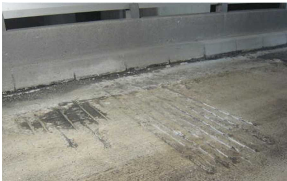
写真-4.1 舗装端部からの水分の浸入によるRC床版の損傷例
