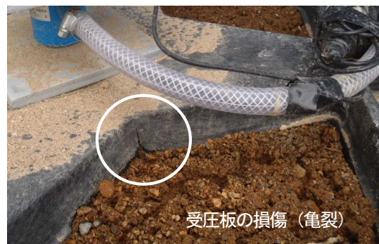
写真-4.2 受圧板 (CASE①) の損傷状況
