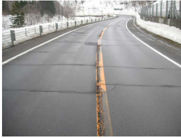
写真-2.1 低温ひび割れ
