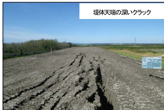
写真1 施工途中で発生した堤体の変状
