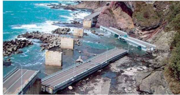
図-1 2004 年 8 月の台風 18 号による神恵内村大森大橋落橋の様子 (寒地土木研究所 HP、平成 16 年台風 18 号による大森大橋被害調査より)
