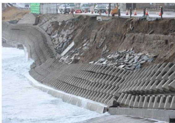
図-9 高波により海岸道路の護岸法面が被災した様子 (江差町、2014年12月4日、北海道開発局函館開発建設部報道資料)
