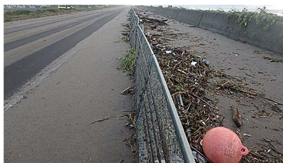
図-17 高波により道路に砂礫等が打ち上がった様子（長万部町、北海道開発局函館開発建設部提供）
