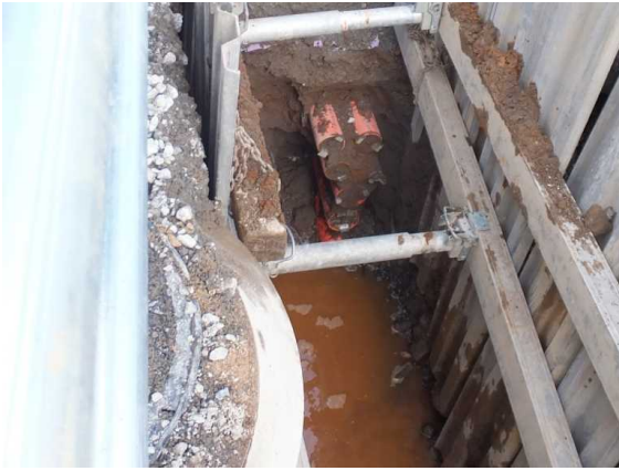
写真-3.2 掘削地盤内の出水状況
