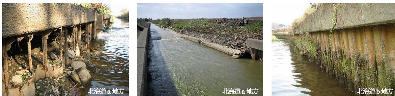
図-6 北海道内における農業用排水路を構成する鋼矢板の腐食
