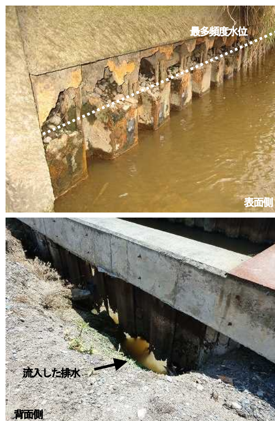
図-8 鋼矢板の腐食の代表的な現況
