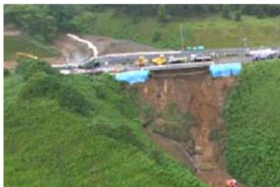
(a) 崩壊状況
