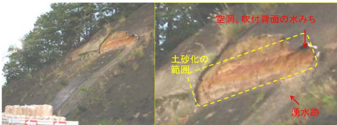
写真 2-17 吹付工オーバーハング部の崩落事例
