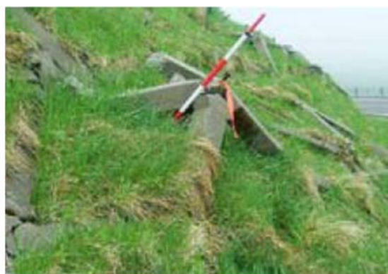
(b) 凍上による浮き上がり
