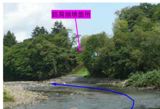
写真 2-10 河川増水による洗掘崩壊箇所の例
