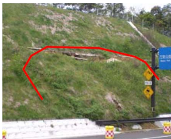
写真2-11 谷部の切土箇所の事例（脆弱部残存）
