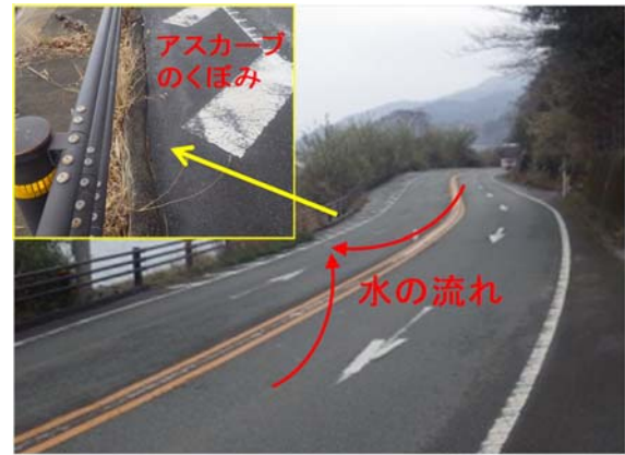
写真 2-5 アスカーブ箇所(滞水⇒オーバーフロー)
