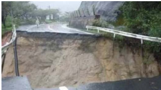
(a) 崩壊状況
