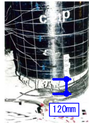
図-4.8 No. 8 供試体の損傷状況 4-12)
