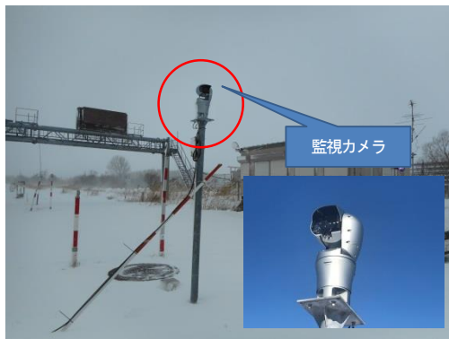
写真-23 監視カメラ設置状況
