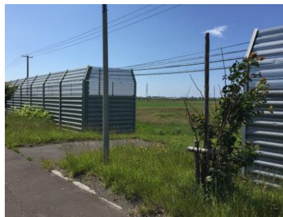
図-2 3 調査区間に設けられている副防雪柵
