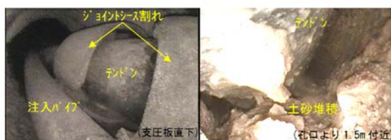
写真-3.4 アンカーの内視鏡カメラ画像 (調査地①)
