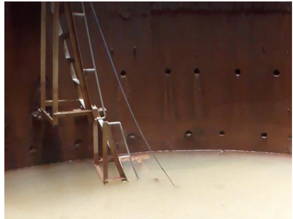
図-11 湛水の状況（排水管の閉塞）
