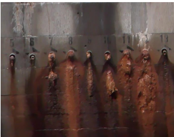
図-10 集水管の閉塞の状況
