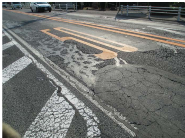
写真 2-1 修繕工事現場の路面状況
