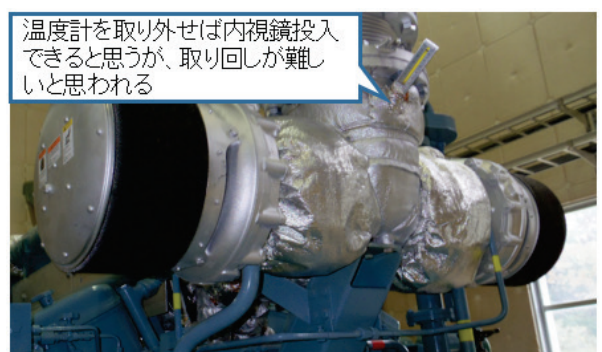
写真-8 新1号原動機の過給器
