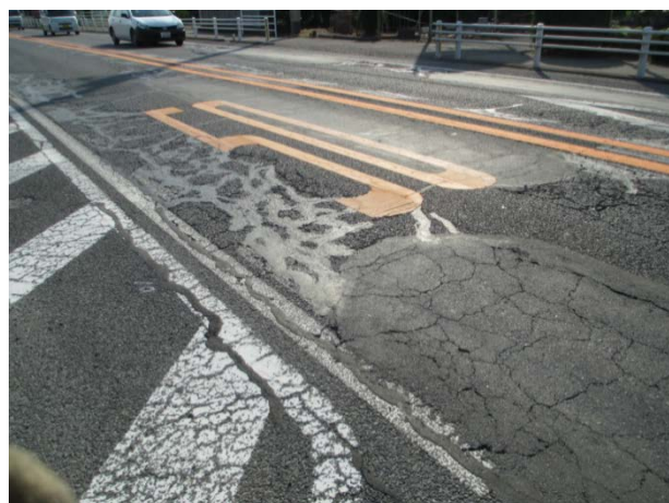
写真2-1 修繕工事現場の路面状況
