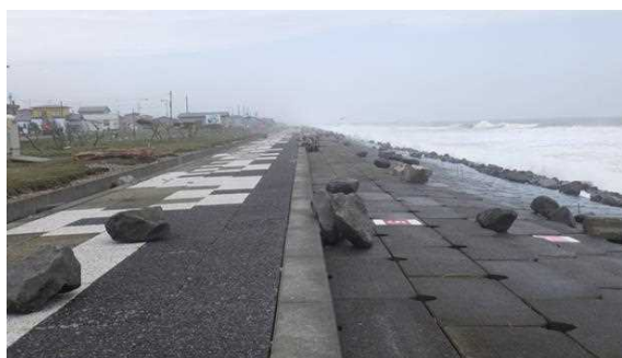
図-2 2016年8月の台風10号による胆振海岸被災の様子(寒地土木研究所撮影)
