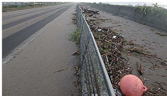
図-17 高波により道路に砂礫等が打ち上がった様子（長万部町、北海道開発局函館開発建設部提供）
