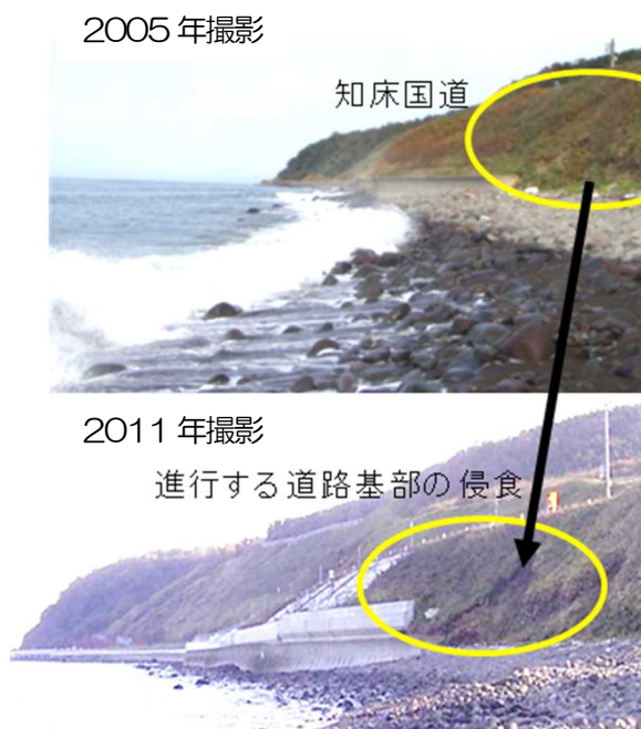
図-18 波浪による道路下斜面の侵食の様子（斜里郡斜里町、国道334号、北海道開発局道路維持課提供）
