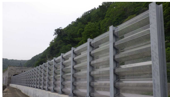
図-15 透明ポリカーボネート製の越波防止柵（国道 336 号、広尾町美幌覆道付近、寒地土木研究所撮影）
