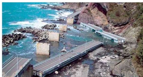
図-1 2004年8月の台風18号による神恵内村大森大橋落橋の様子(寒地土木研究所HP、平成16年台風18号による大森大橋被害調査より)
