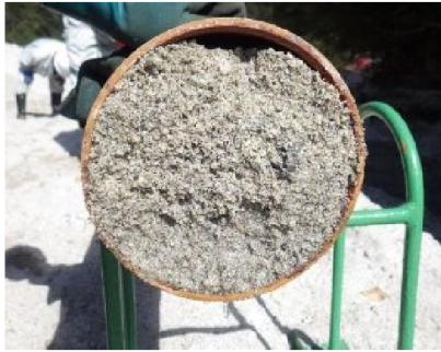
図-8 管閉塞の状況
