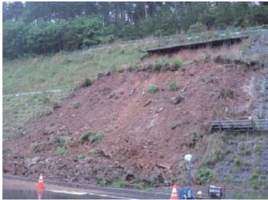
(a) 被災箇所の状況
