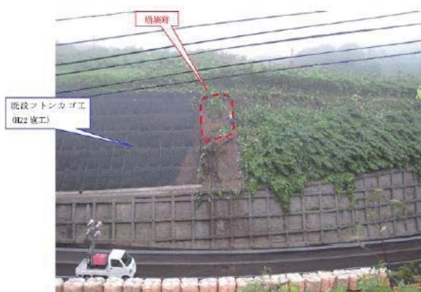
(a) 被災箇所の状況
