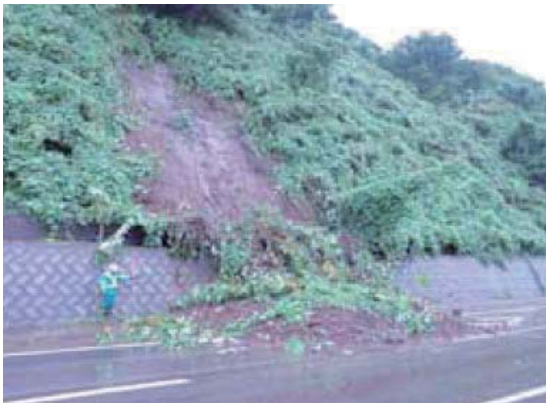
(a) 被災箇所状況
