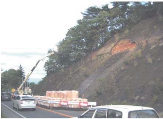
(a) 被災箇所状況
