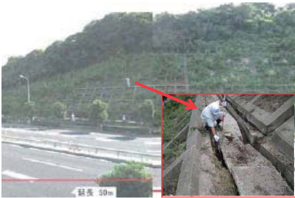
(a) 被災箇所の状況
