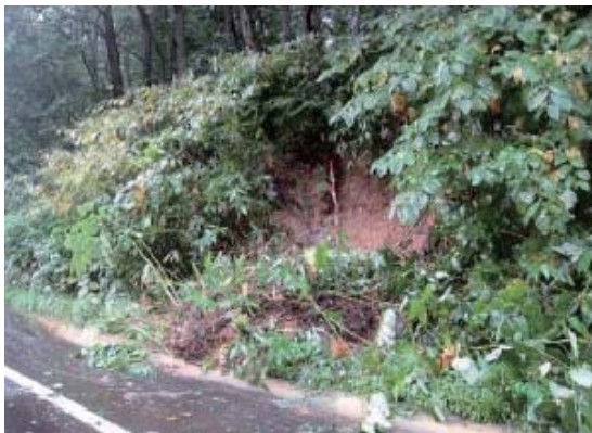
(a) 被災箇所の状況
