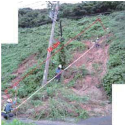
(a) 被災箇所状況
