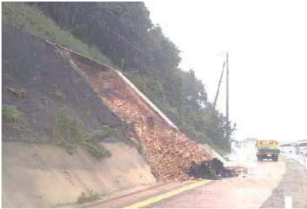
(a) 被災箇所状況
