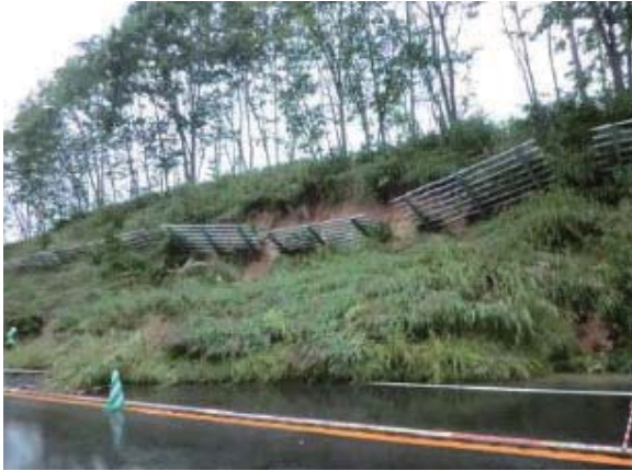
(a) 被災箇所状況
