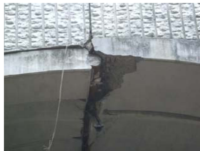
写真-3 ヒンジ部の損傷 (その2)
