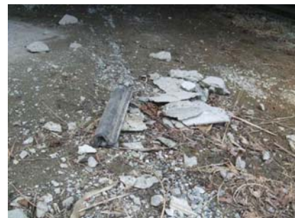
写真-4 落下したコンクリート片
