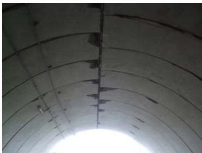
写真-2 ヒンジ部の損傷 (その1)
