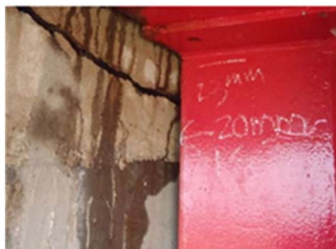
図-6 A1 橋台パラペット上部のクラック
