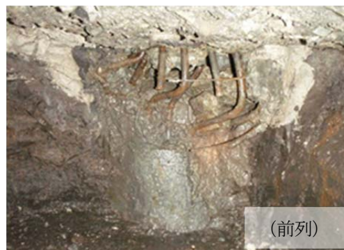
図-7 A1 橋台の杭頭部の損傷状況(下流側)
