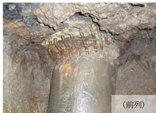
図-8 A2 橋台の杭頭部の損傷状況(下流側)
