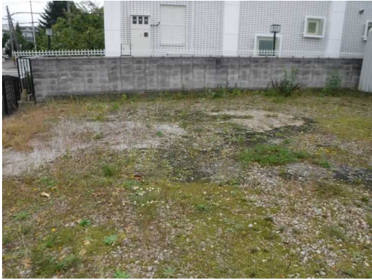
図-2.16 調査箇所②で確認された噴砂 (2018年9月9日撮影)
