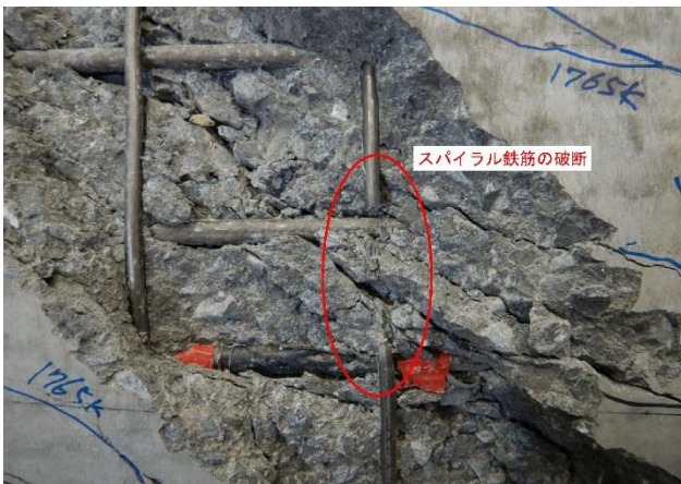
(b) 鉄筋破断箇所
