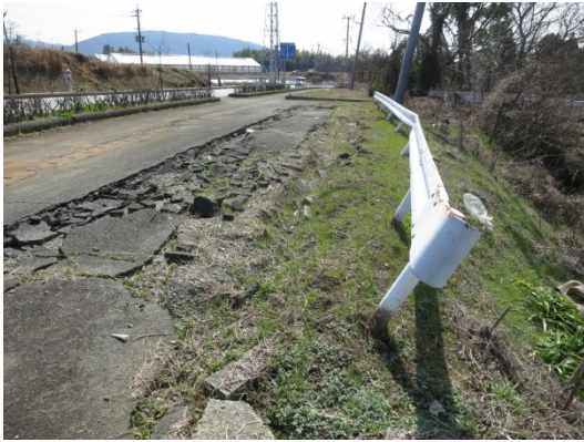
図-1 盛土変状箇所
