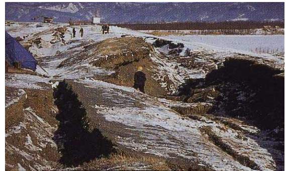
写真-1 1993年釧路沖地震における河川堤防(十勝川統内築堤)の被災状況 10)
